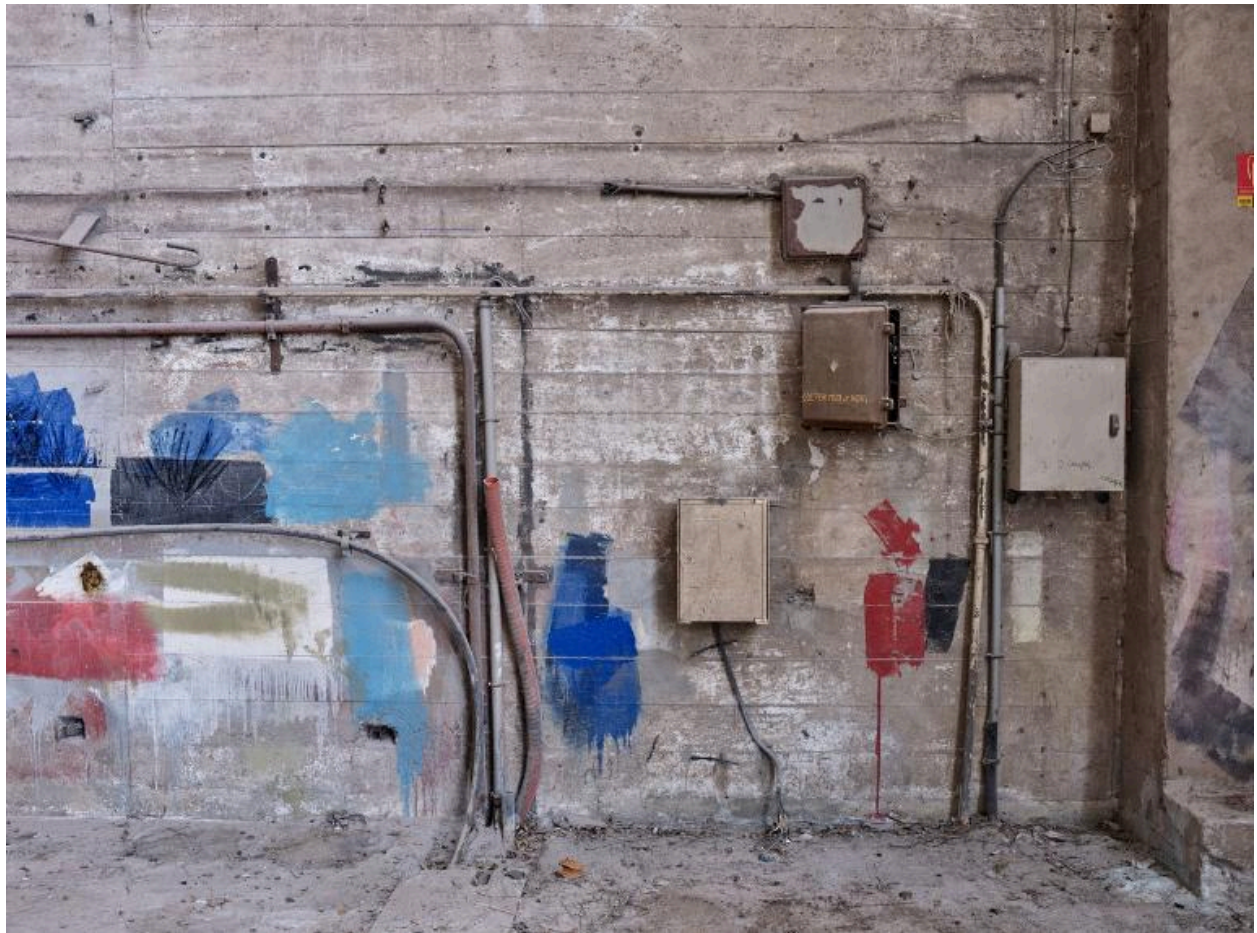
Vue des différents fluides et réseaux sur le mur intérieur ouest
