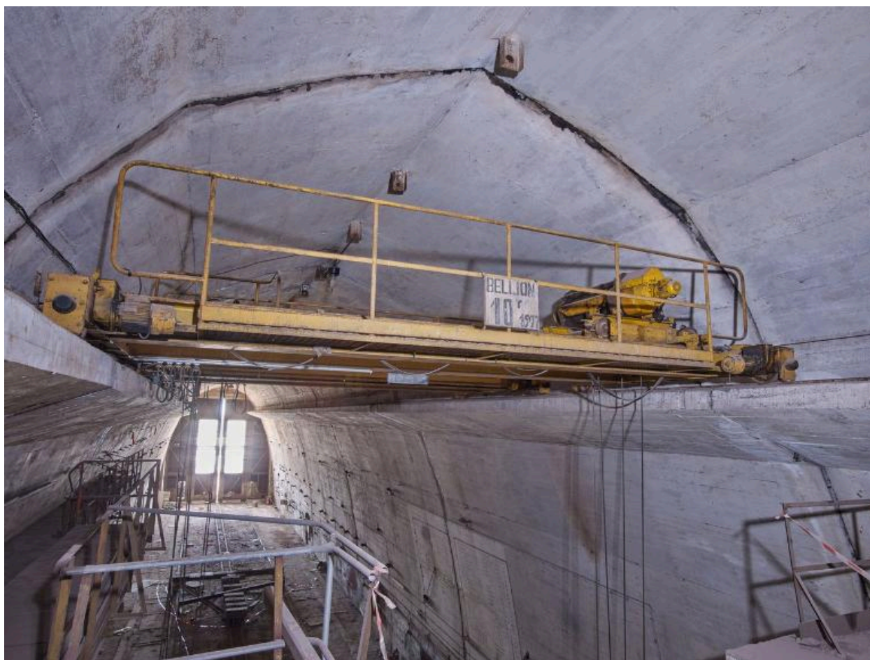
Vue générale du pont roulant avant doté de ses deux treuils (pont roulant français de marque Bellion daté de 1977)
