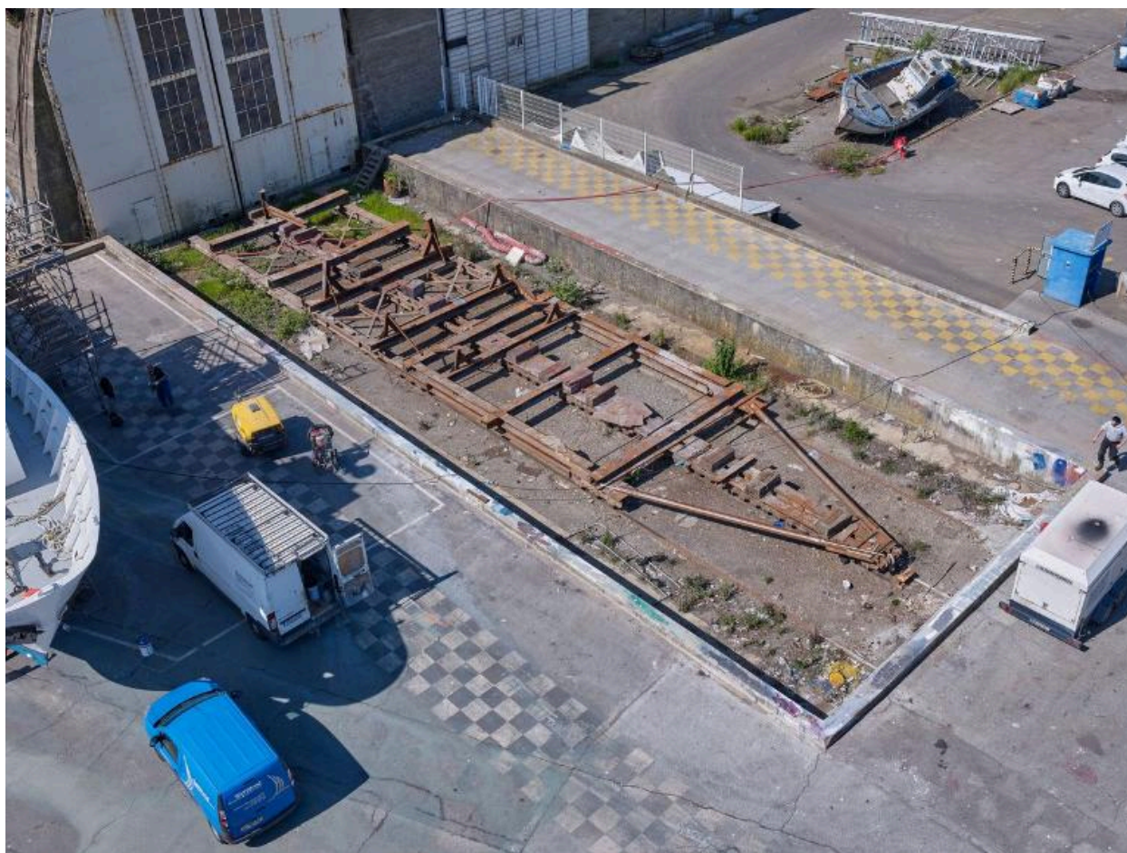
Vue générale du chariot de manutention dans sa fosse
