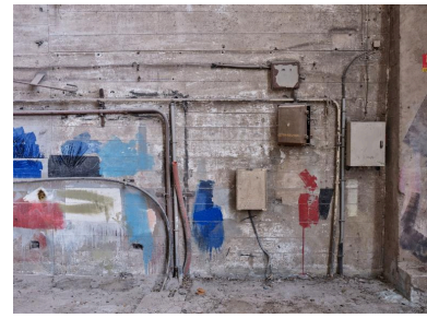
Vue des différents fluides et réseaux sur le mur intérieur ouest Phot. Bernard Bègne IVR53_20225600531NUCA
