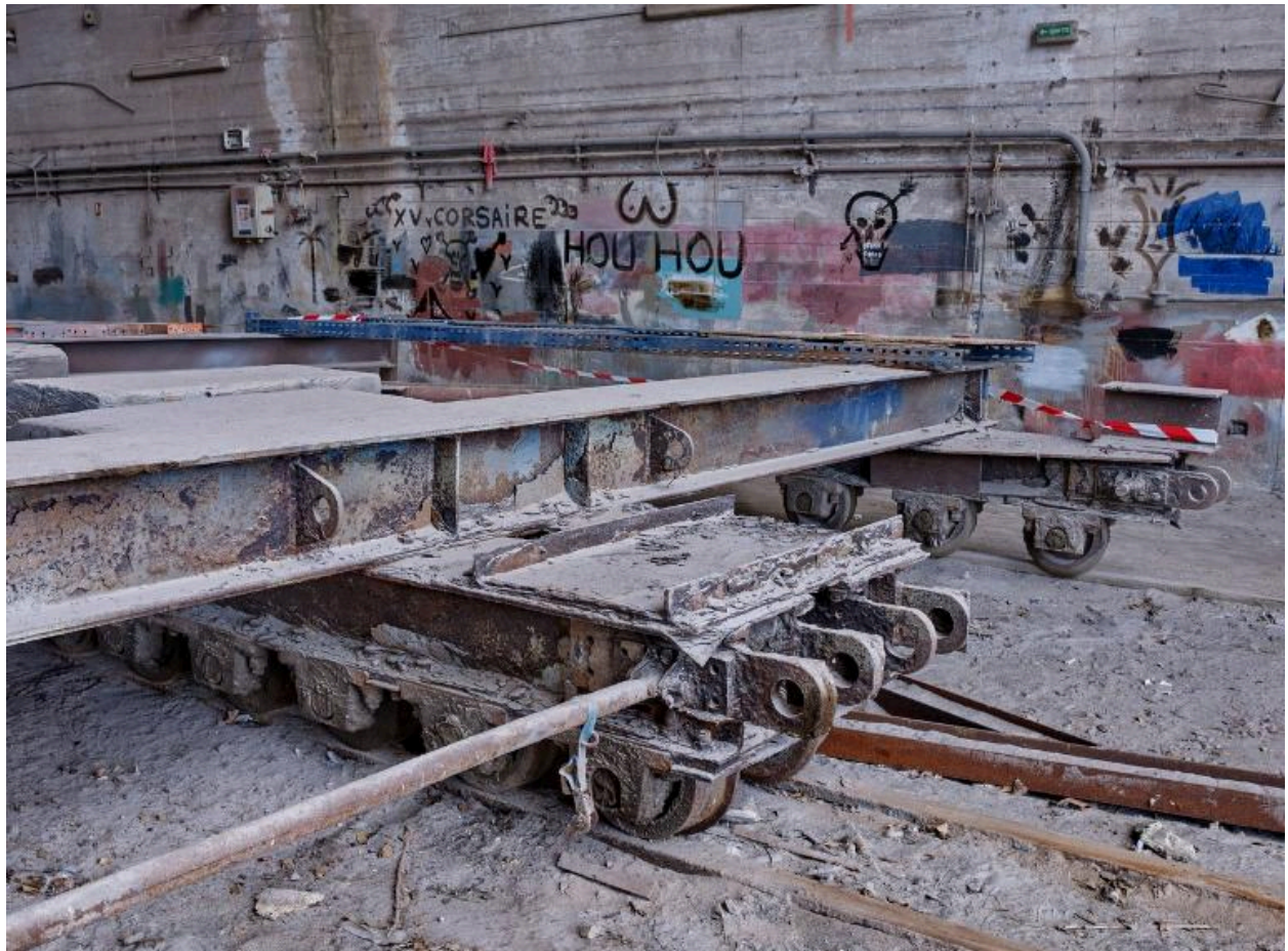
Vue d'une partie du ber du slipway sur ses quatre rails. Ici, un point de raccordement du ber
