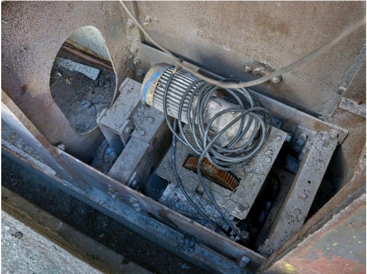
Vue intérieure de l'un des deux volets de la porte blindée nord : système motorisé permettant l'ouverture de la porte
