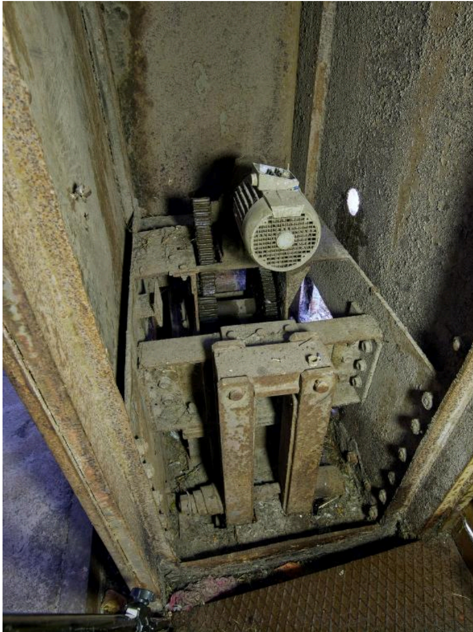
Vue intérieure de l'un des deux volets de la porte blindée nord : système motorisé permettant le blocage de la porte
