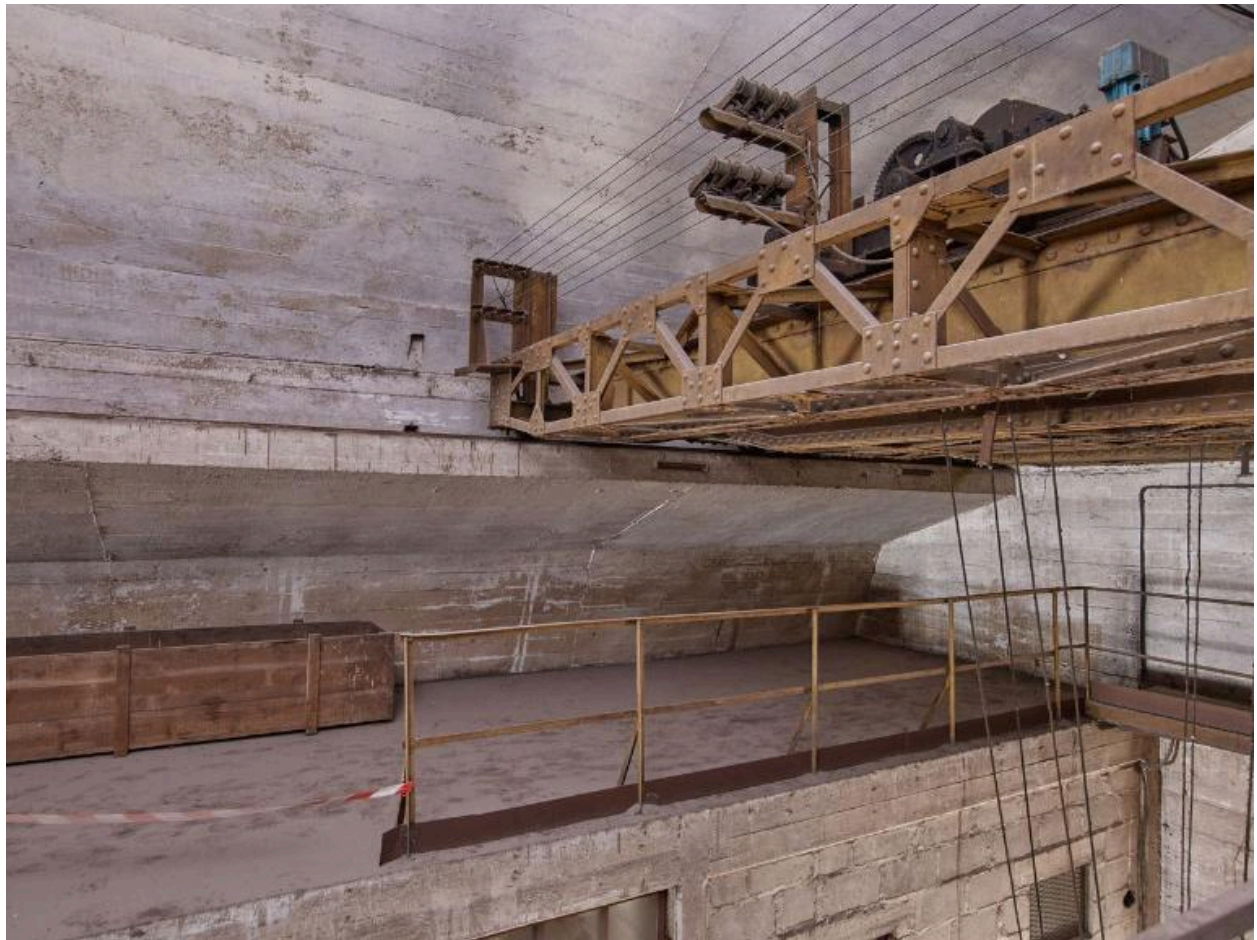
Vue de détail du pont roulant arrière doté de ses deux treuils (pont roulant de la période allemande)
