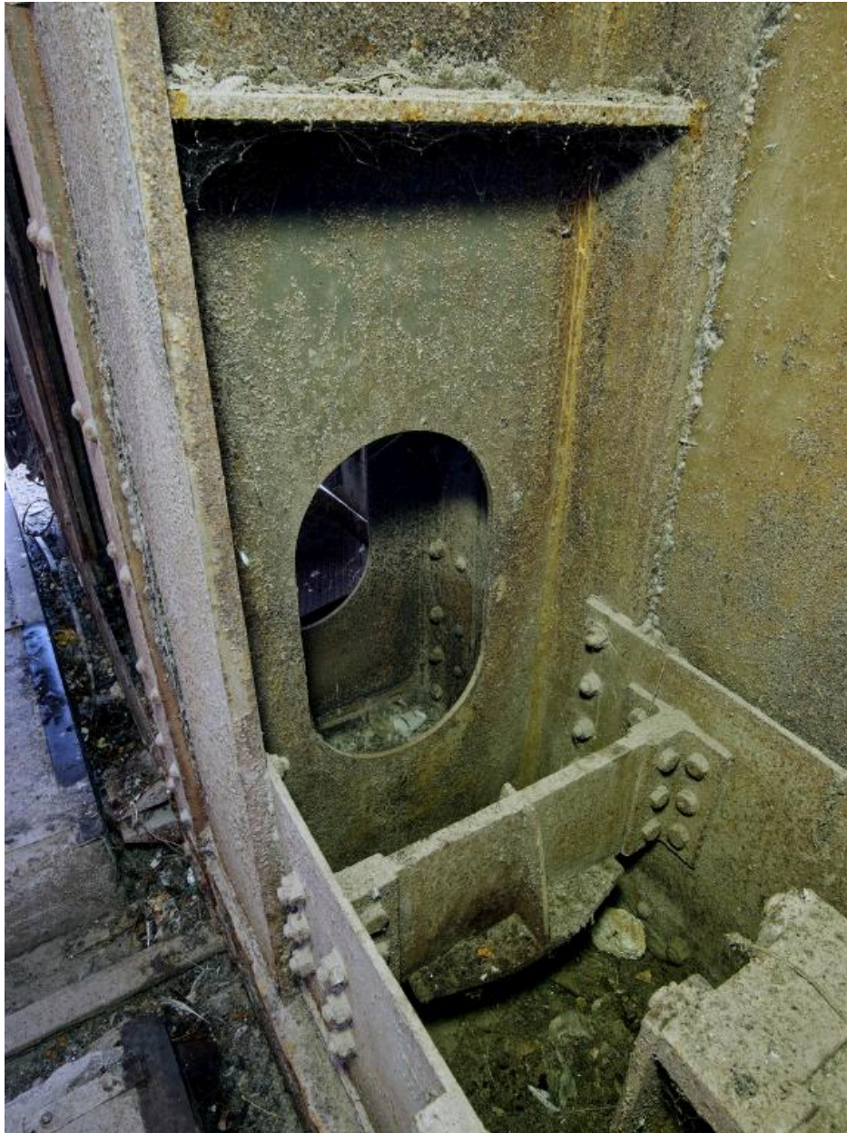
Vue intérieure de l'un des deux volets de la porte blindée nord. La porte est assemblée comme une double coque de bateau
