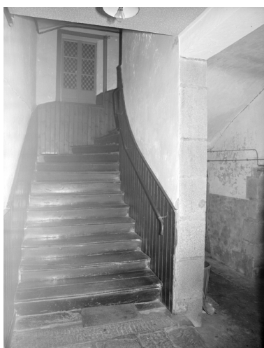
37 rue Nationale, escalier et mur noyau, vue de la première volée. Phot. Guy Artur IVR53_19783500256X
