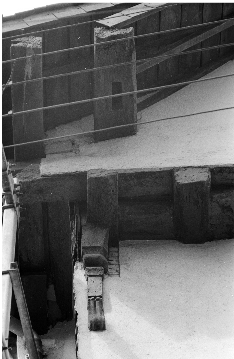
Détail de l'encorbellement au troisième étage, console et mortaise orpheline, état en 1974
