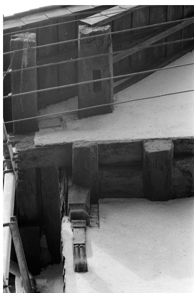
Détail de l'encorbellement au troisième étage, console et mortaise orpheline, état en 1974 Phot. Marie-Madeleine Tugores IVR53_19742907177Z
