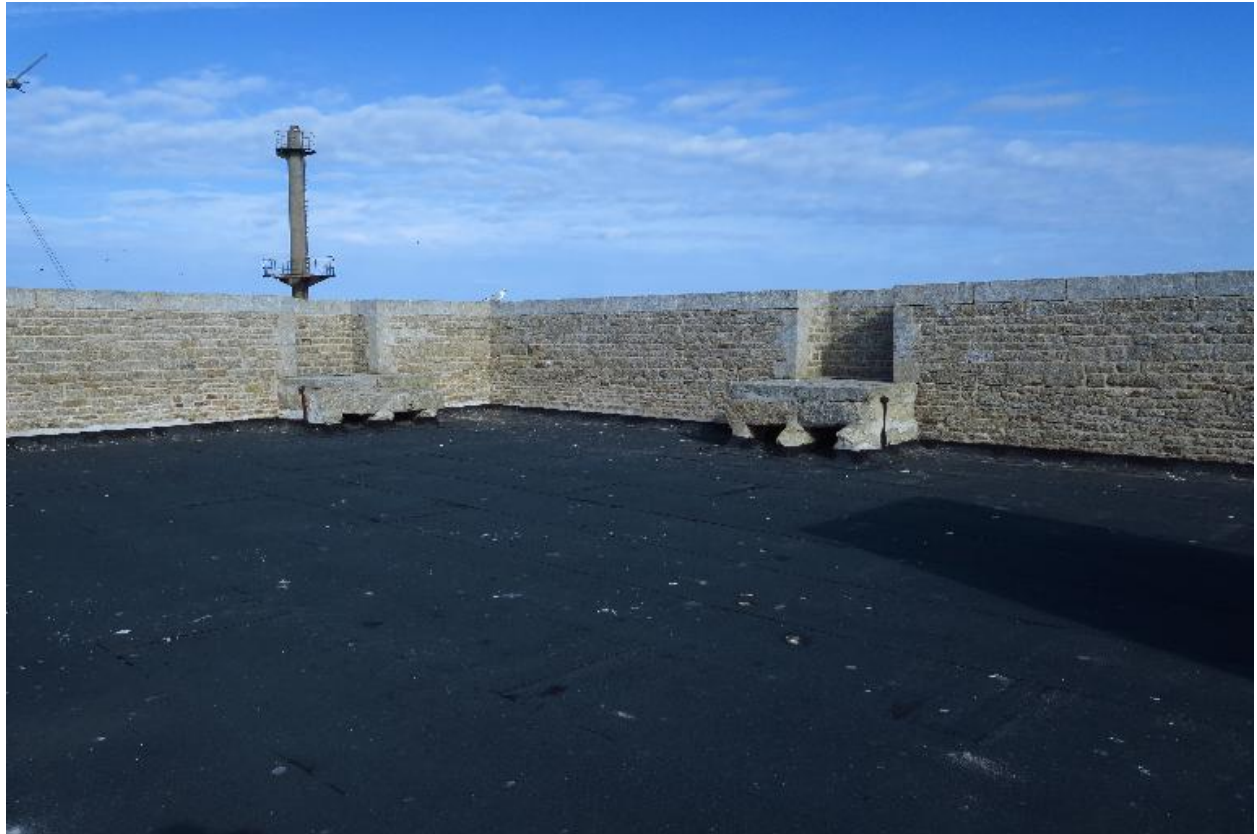
Archipel des Glénan, batterie de Penfret, corps de garde crénelé, parapet après destruction de ses banquettes en terre.
