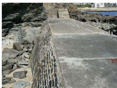
Plateforme, escalier et partie supérieure de la cale des Grands-Sables Phot. Julien Amghar IVR53_20082908645NUCA
