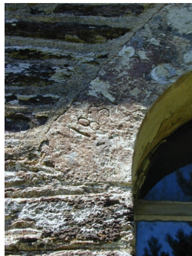
C ti re sud, premi re baie   partir de l'ouest : d tail de la date grav e Phot. Xavier Gilbert IVR53_20023510574NUCA
