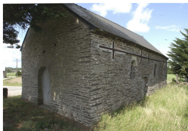
La c ti re sud : vue g n rale sud-ouest Phot. Guy Artur, Phot. Norbert Lambert IVR53_20023503189NUCA
