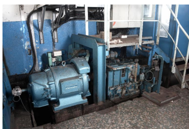
Poste de commande : système de levage, moteur, frein Phot. Bernard Bègne IVR53_20162900618NUCA
