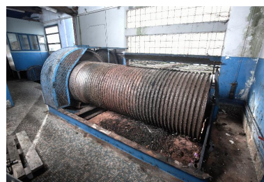
Poste de commande : système de levage, treuil, câble Phot. Bernard Bègne IVR53_20162900623NUCA
