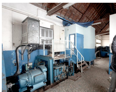
Poste de commande : système de levage, moteur, frein Phot. Bernard Bègne IVR53_20162900619NUCA
