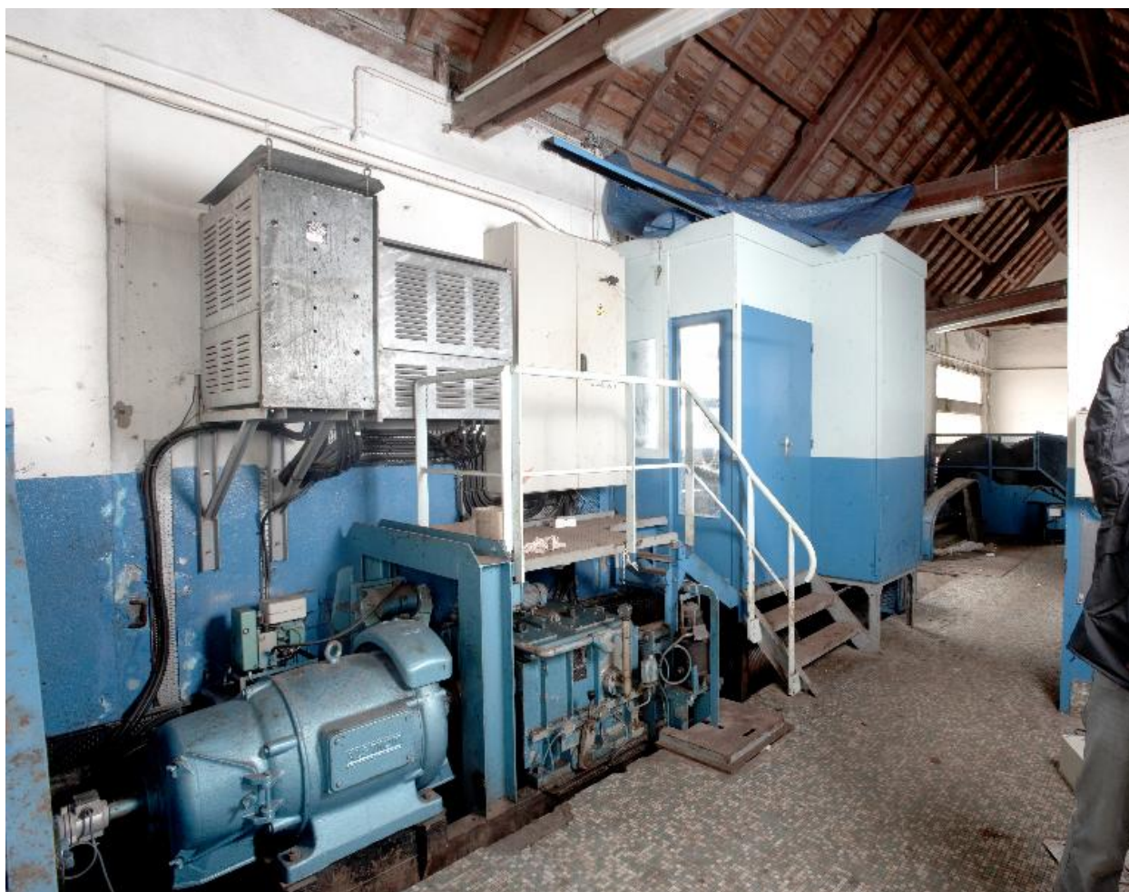
Poste de commande : système de levage, moteur, frein
