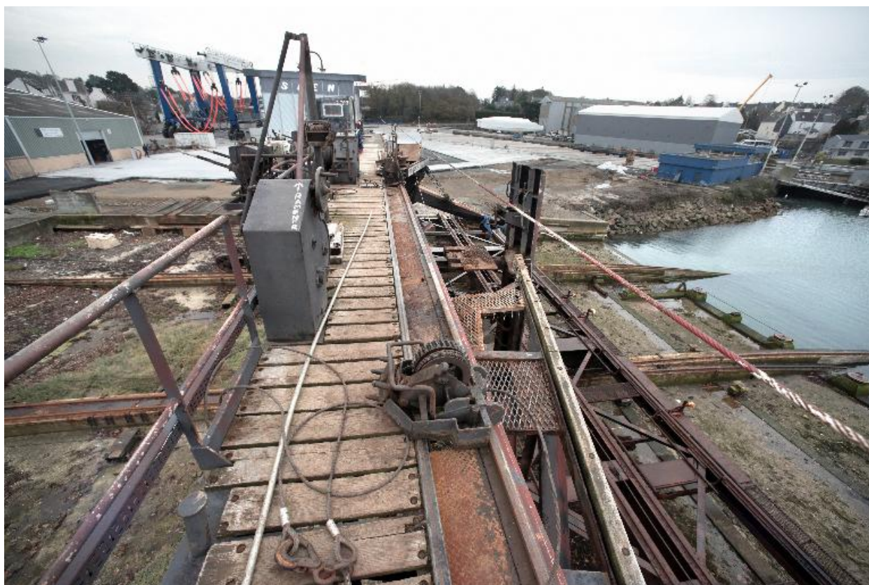
Passerelle : système mécanique
