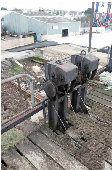
Passerelle : système mécanique Phot. Bernard Bègne IVR53_20162900674NUCA
