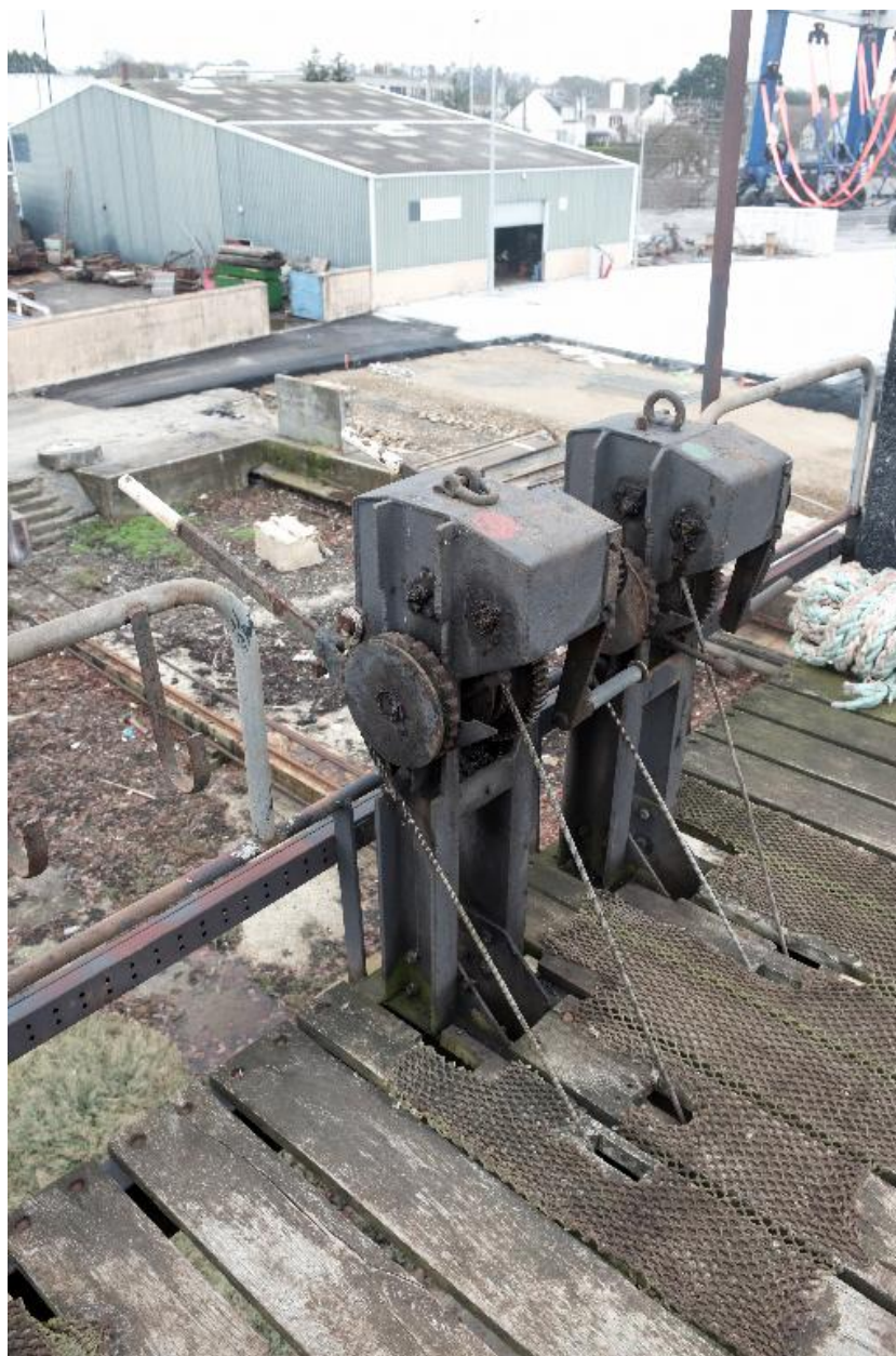
Passerelle : système mécanique
