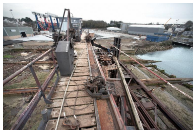
Passerelle : système mécanique Phot. Bernard Bègne IVR53_20162900682NUCA
