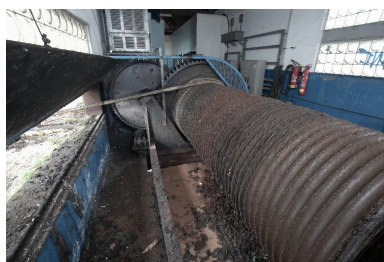
Poste de commande : système de levage, treuil, câble Phot. Bernard Bègne IVR53_20162900621NUCA
