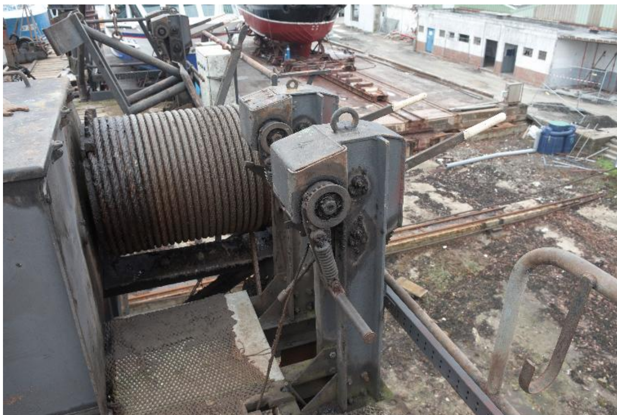
Passerelle : système mécanique, treuil
