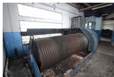
Poste de commande : système de levage, treuil, câble Phot. Bernard Bègne IVR53_20162900620NUCA
