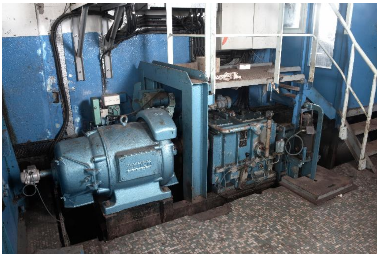
Poste de commande : système de levage, moteur, frein
