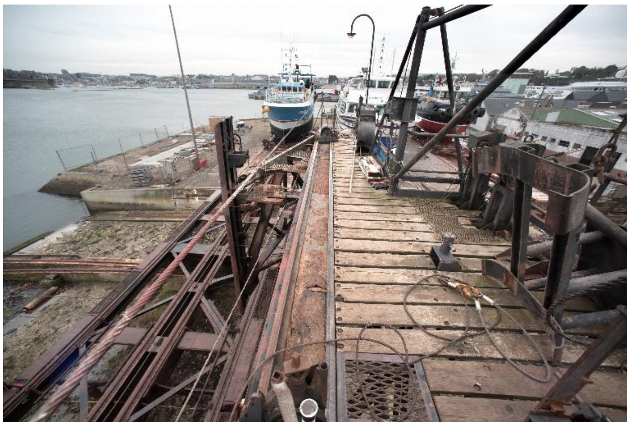
Passerelle : système mécanique
