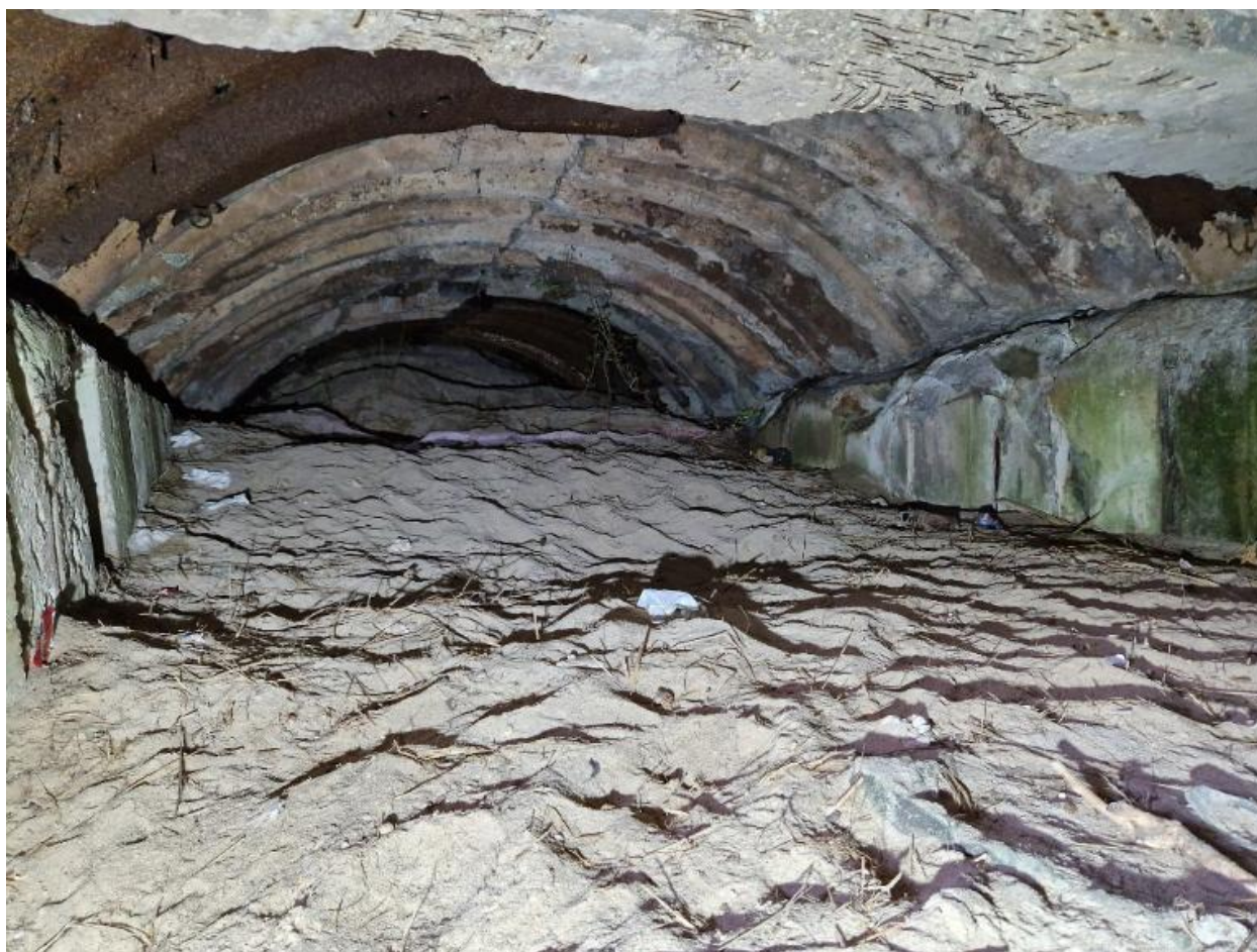
Vue intérieure : salle de garde couverte en tôle métro. En partie disloqué, le bunker est envahi par le sable
