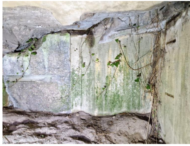
Vue intérieure : entrée de la salle de garde. Le mur du couloir d'accès a été soufflé par une explosion interne. En partie disloqué, le bunker est envahi par le sable Phot. Guillaume Lécueillier IVR53_20252910540NUCA
