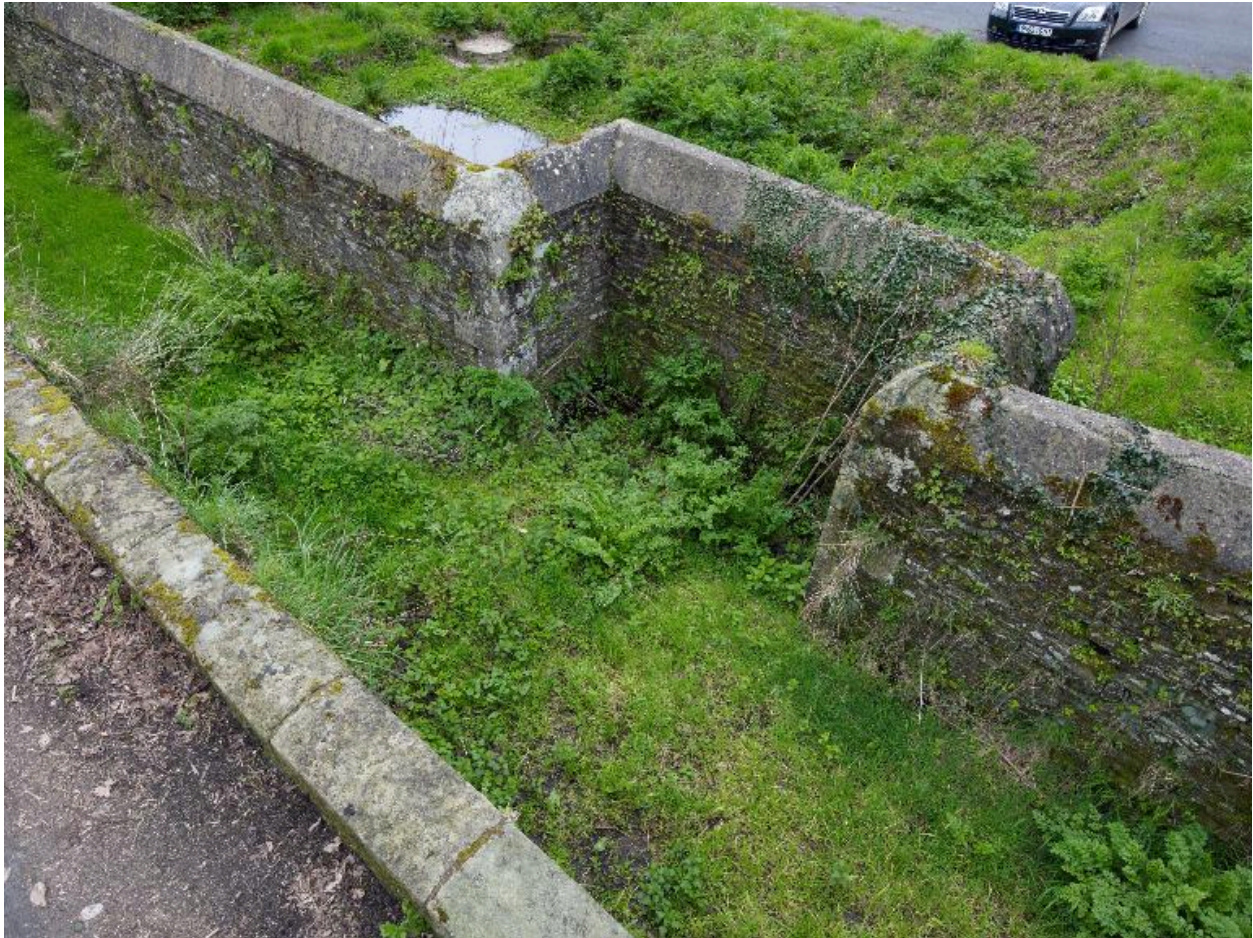
Mur de clôture au sud-ouest du château. Détail de l'encoche pratiquée dans le mur pour abriter la fontaine, accessible depuis la route par une rampe d'accès
