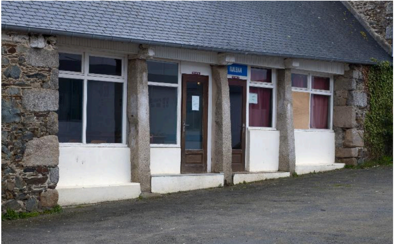
Remise agricole au nord-est du château. Détail du mur ouvert soutenu par trois piles monolithes
