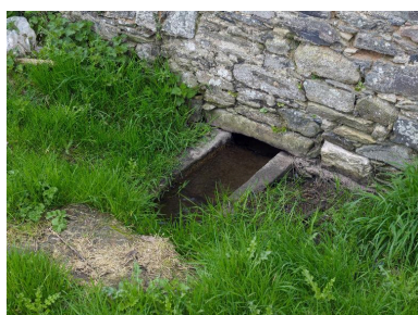
Potager. Détail de la rigole d'irrigation : arrivée d'eau Phot. Bernard Bègne IVR53_20152200449NUCA
