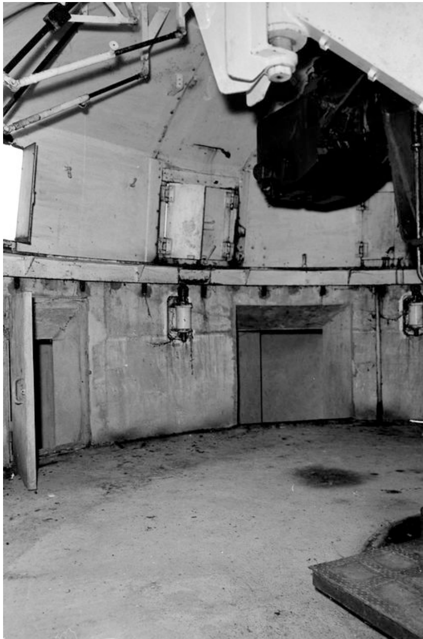
Vue de l'un des quatre canons antiaériens de 10,5 cm sous blindage (état en 1969)
