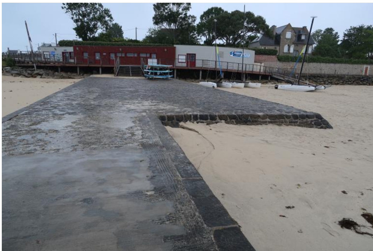
Ancienne digue de Sainte-Evette, depuis le musoir vers le club nautique : ensablement important
