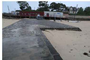
Ancienne digue de Sainte-Evette, depuis le musoir vers le club nautique : ensablement important Phot. Erwana L'Haridon IVR53_20212905668NUCA
