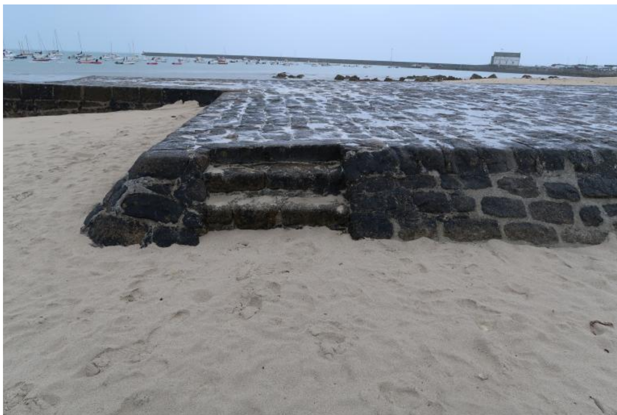
Ancienne digue de Sainte-Evette, escalier côté nord, fort ensablement
