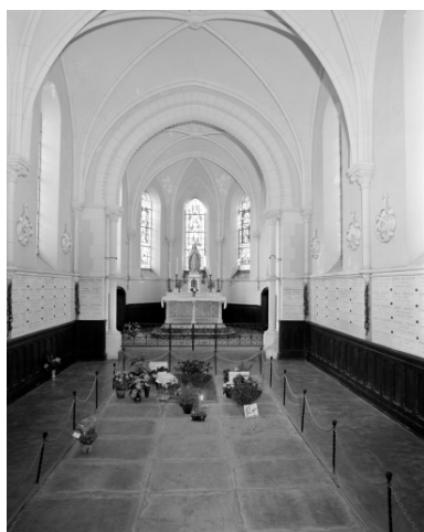
Intérieur : vue générale vers le chœur Phot. Bernard Bègne, Phot. M. Loyon IVR53_19923501002X
