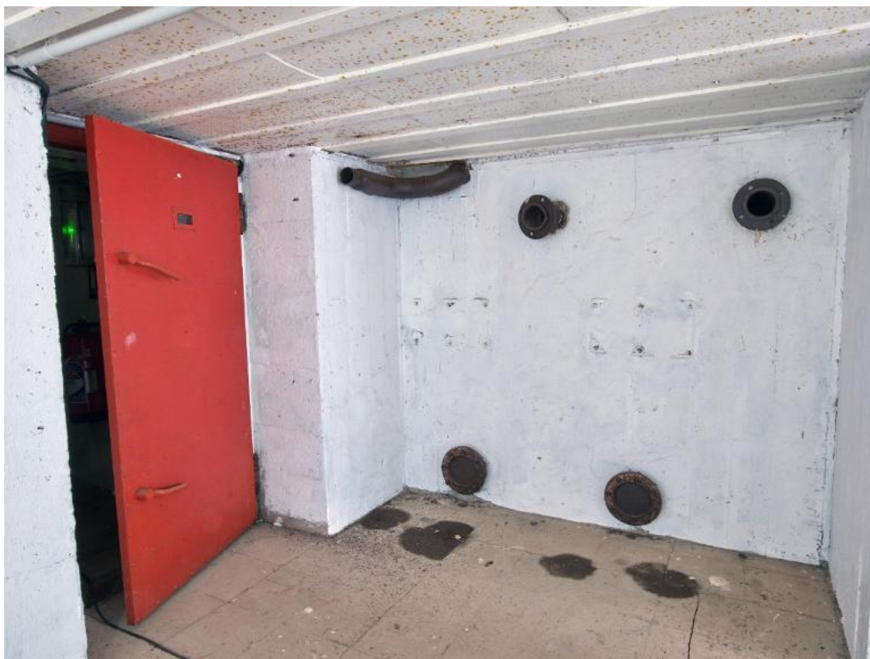
Vue de l'emplacement du système de ventilation : arrivées et prises d'air pour deux ventilateurs (leurs fixations sont visibles sur le mur)
