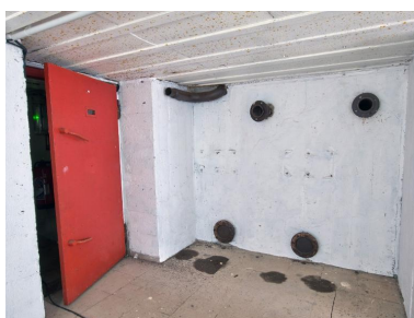
Vue de l'emplacement du système de ventilation : arrivées et prises d'air pour deux ventilateurs (leurs fixations sont visibles sur le mur) Phot. Bernard Bègne IVR53_20235600741NUCA
