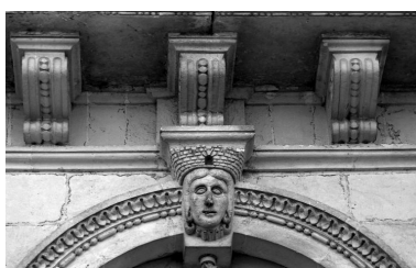
Apigné – château, clefs et consoles façade sud Phot. Sylvie Laffiché, Phot. Marie-Madeleine Tugores IVR53_19753506109Z
