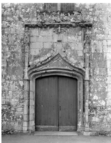
Elévation Ouest, porte principale : vue générale Phot. Guy Artur, Phot. Norbert Lambart IVR53_19943501298X
