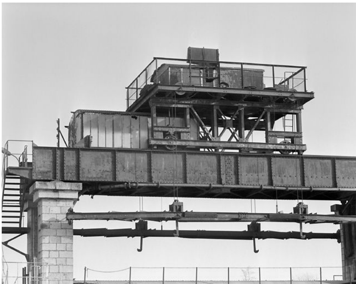
Grand Vannage : détail sur la machinerie de la partie supérieure
