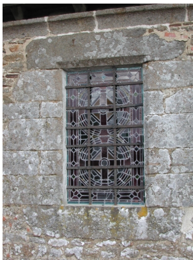
Mur sud de la nef, détail d'une fenêtre Phot. Véronique Orain IVR53_20023505194NUCA
