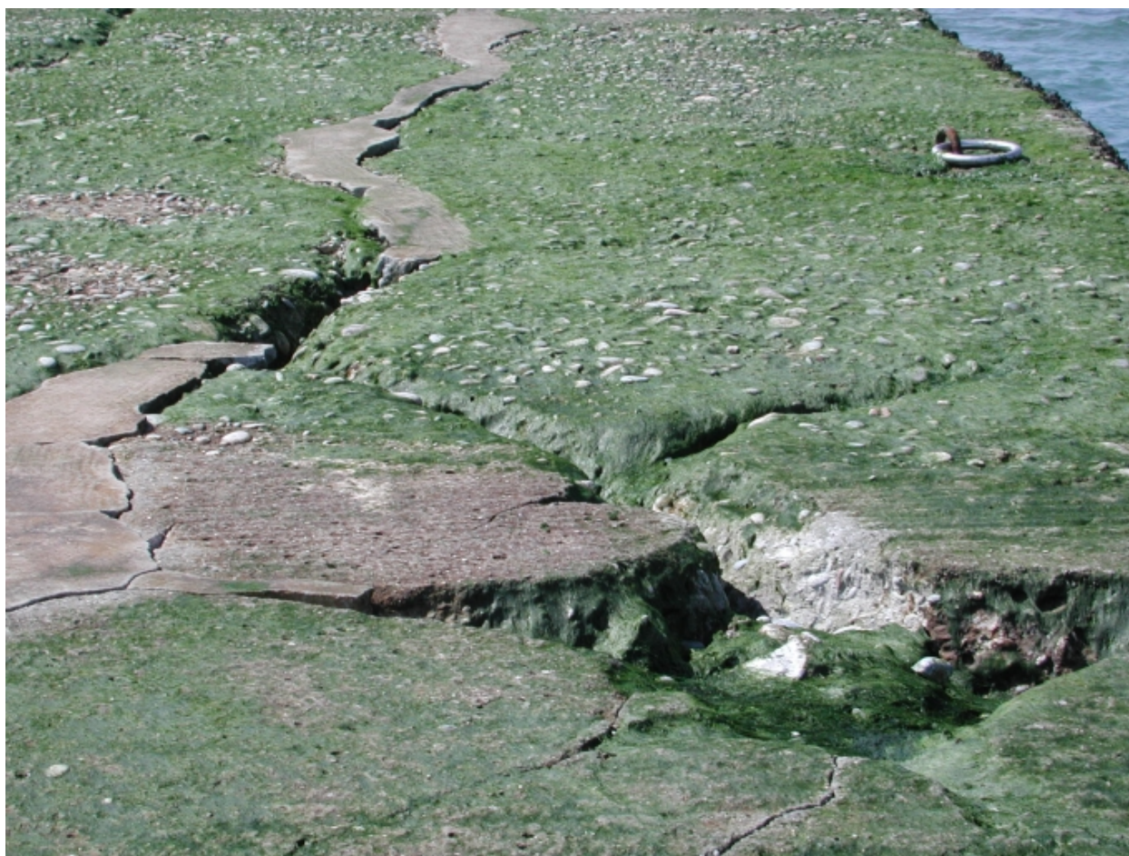
Vue de la partie supérieure de la cale sud lézardée à son extrémité
