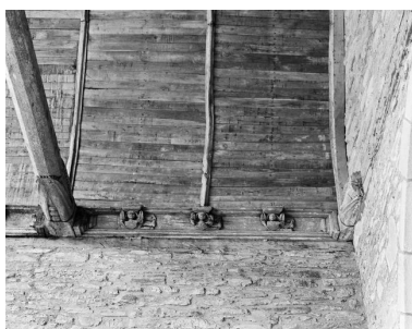
Chapelle, bras sud du transept : sablière côté ouest (état en 1992) Phot. Guy Artur, Phot. Norbert Lambart IVR53_19925601308X
