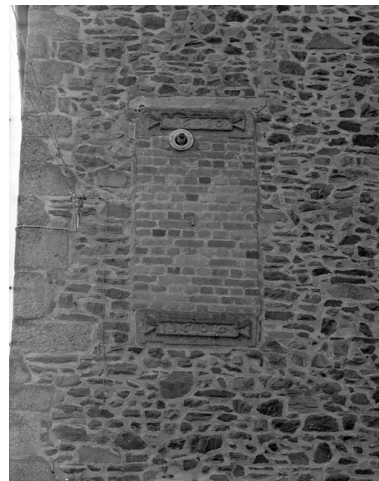
Vue de détail de la fenêtre datée de 1600 et 1610 sur le pignon nord. Phot. Guy Artur IVR53_19783500280X
