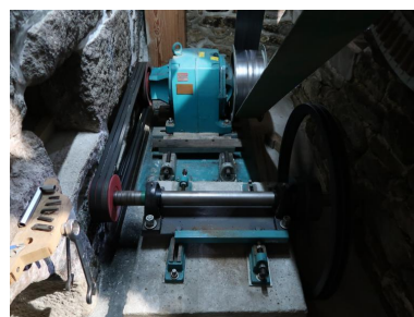
Loguivy-Plougras, le bourg : Moulin à eau de Traou an Dour, détail des mécanismes de transmission (alternateur) Phot. Guillaume Lécueillier IVR53_20192205297NUCA
