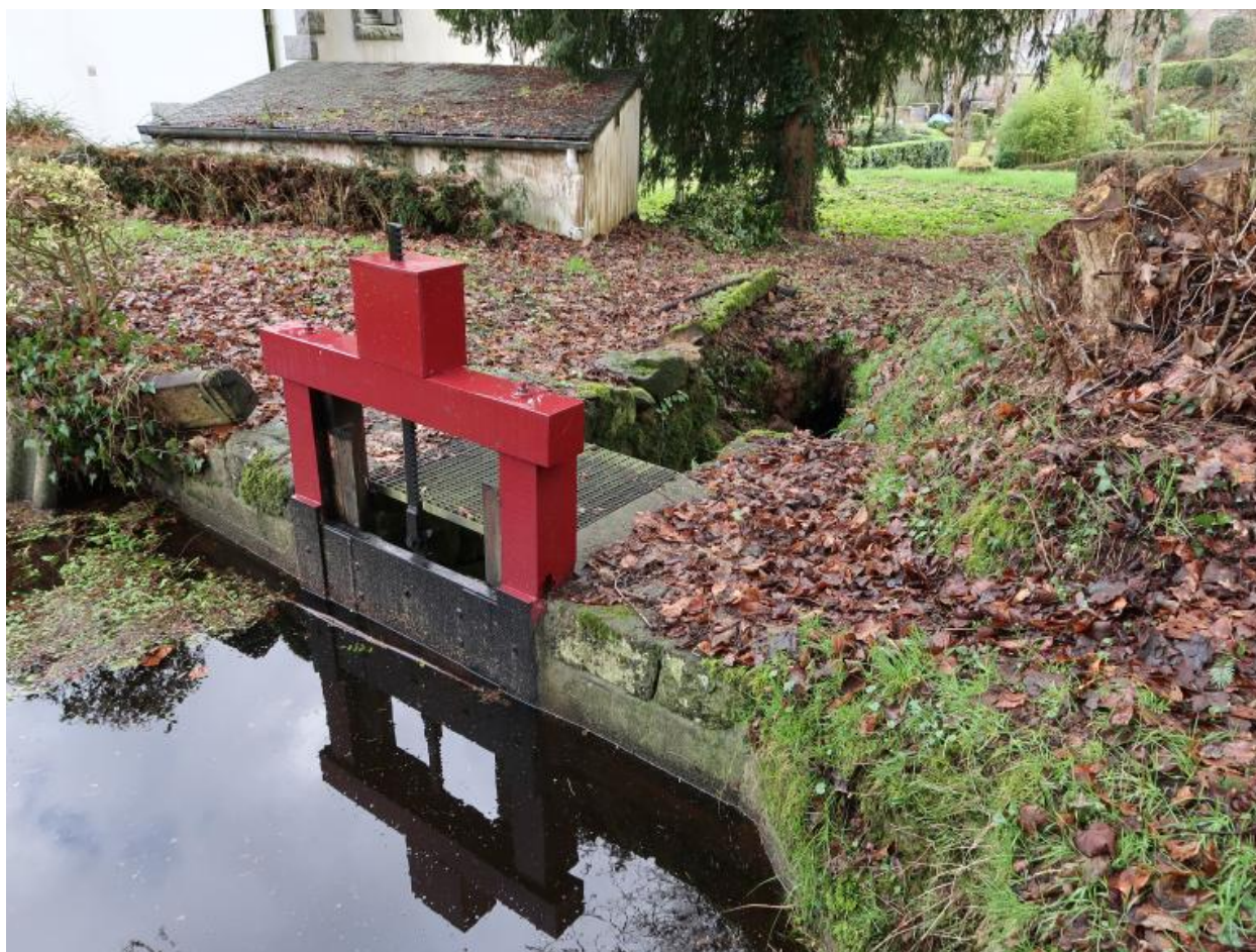
Loguivy-Plougras, le bourg : Moulin à eau de Traou an Dour, entrée de la rigole du canal d'amenée (vanne permettant de réguler ou fermer l'alimentation en eau depuis l'étang)
