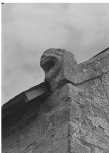
Elévation ouest : détail de la pierre d'assise nord Phot. François Dagorn IVR53_19683500325V
