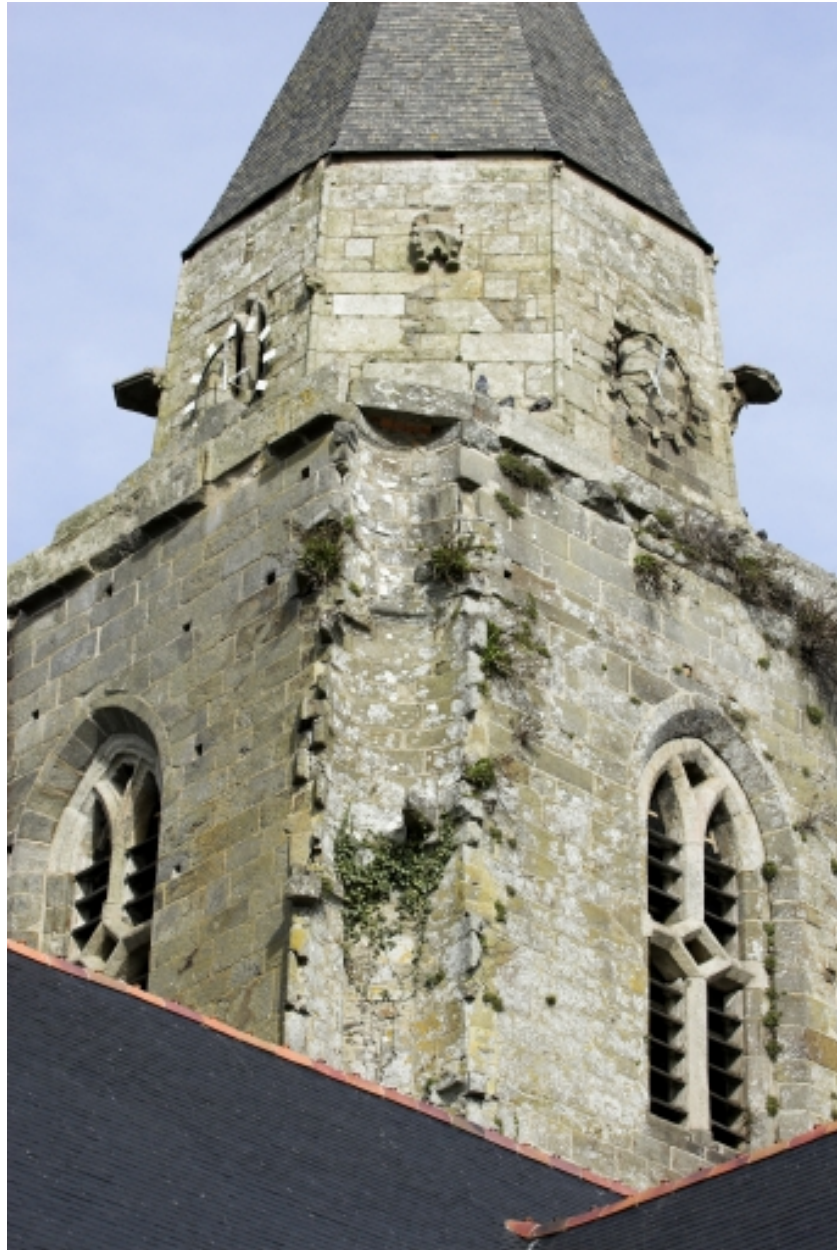
Tour-clocher, détail, arrachements
