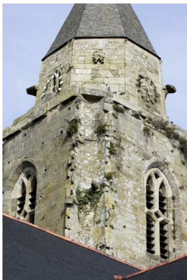
Tour-clocher, détail, arrachements Phot. Bernard Bègne IVR53_20073500089NUCA
