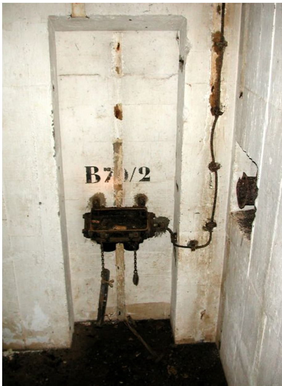
Vue du boîtier de connexion téléphonique surmonté du marquage B 70/2
