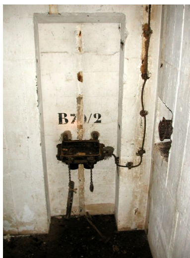
Vue du boîtier de connexion téléphonique surmonté du marquage B 70/2 Phot. Guillaume Lécueillier IVR53_20062904857NUCA
