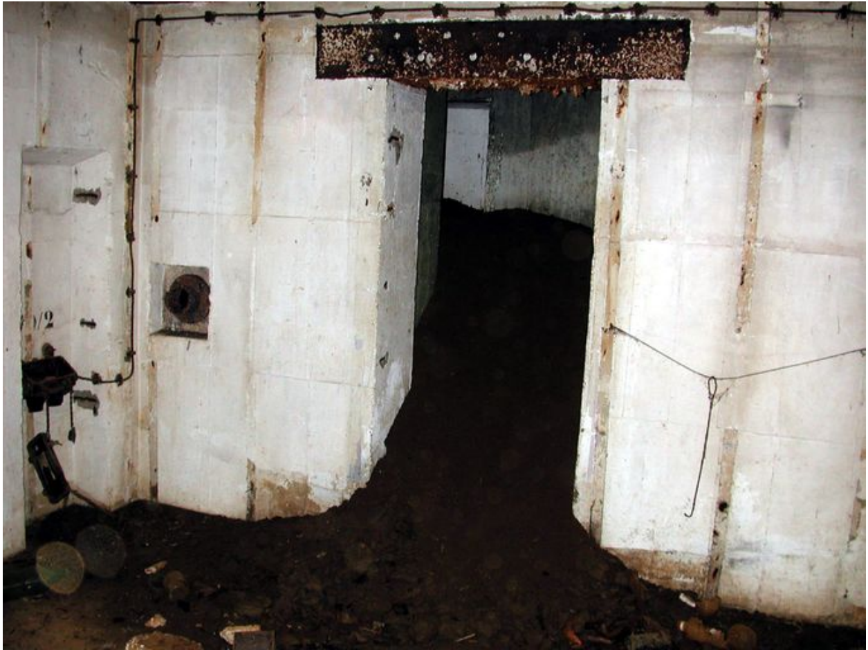
Vue intérieure : entrée de la salle de garde. A droite dans sa niche, boîtier de connexion téléphonique surmonté du marquage B 70/2
