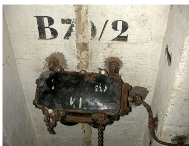
Vue du boîtier de connexion téléphonique - en position fermé - surmonté du marquage B 70/2 Phot. Guillaume Lécueillier IVR53_20062904858NUCA
