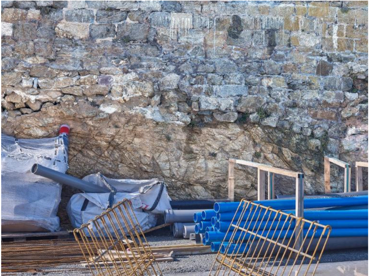
Vue de détail de l'intérieur de l'escarpe (couverture photographique du 22 janvier 2026). Au premier plan, le chantier de la gare maritime du Naye
