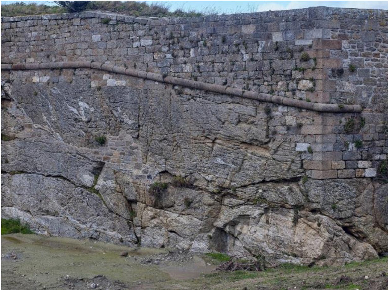
Vue générale depuis l'ouest-sud-ouest (couverture photographique du 22 janvier 2026). Fondée sur le rocher, cette partie du fort est montée en maçonnerie de pierre de taille
