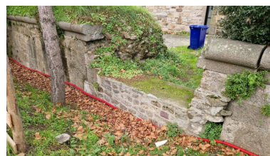
Vue des vestiges de l'escarpe à l'est, le long du rond-point du Naye (couverture photographique du 17 décembre 2025) Phot. Guillaume Lécueillier IVR53_20263510072NUCA
