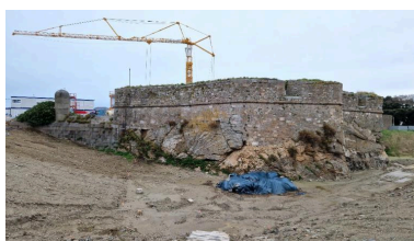
Vue générale depuis l'ouest-sud-ouest (couverture photographique du 17 décembre 2025) Phot. Guillaume Lécueillier IVR53_20263510076NUCA
