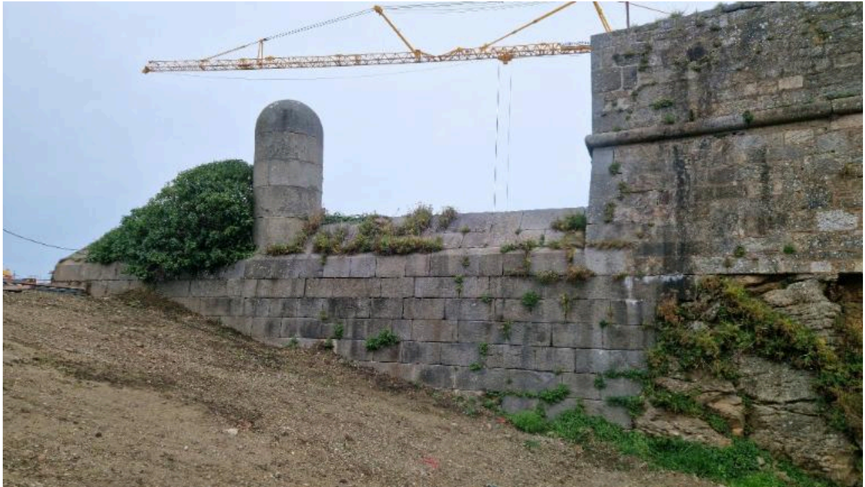
Vue de la digue et de la dame du fossé du fort depuis l'ouest-sud-ouest (couverture photographique du 17 décembre 2025). Cette partie du fort est montée en maçonnerie de pierre de taille de granite
