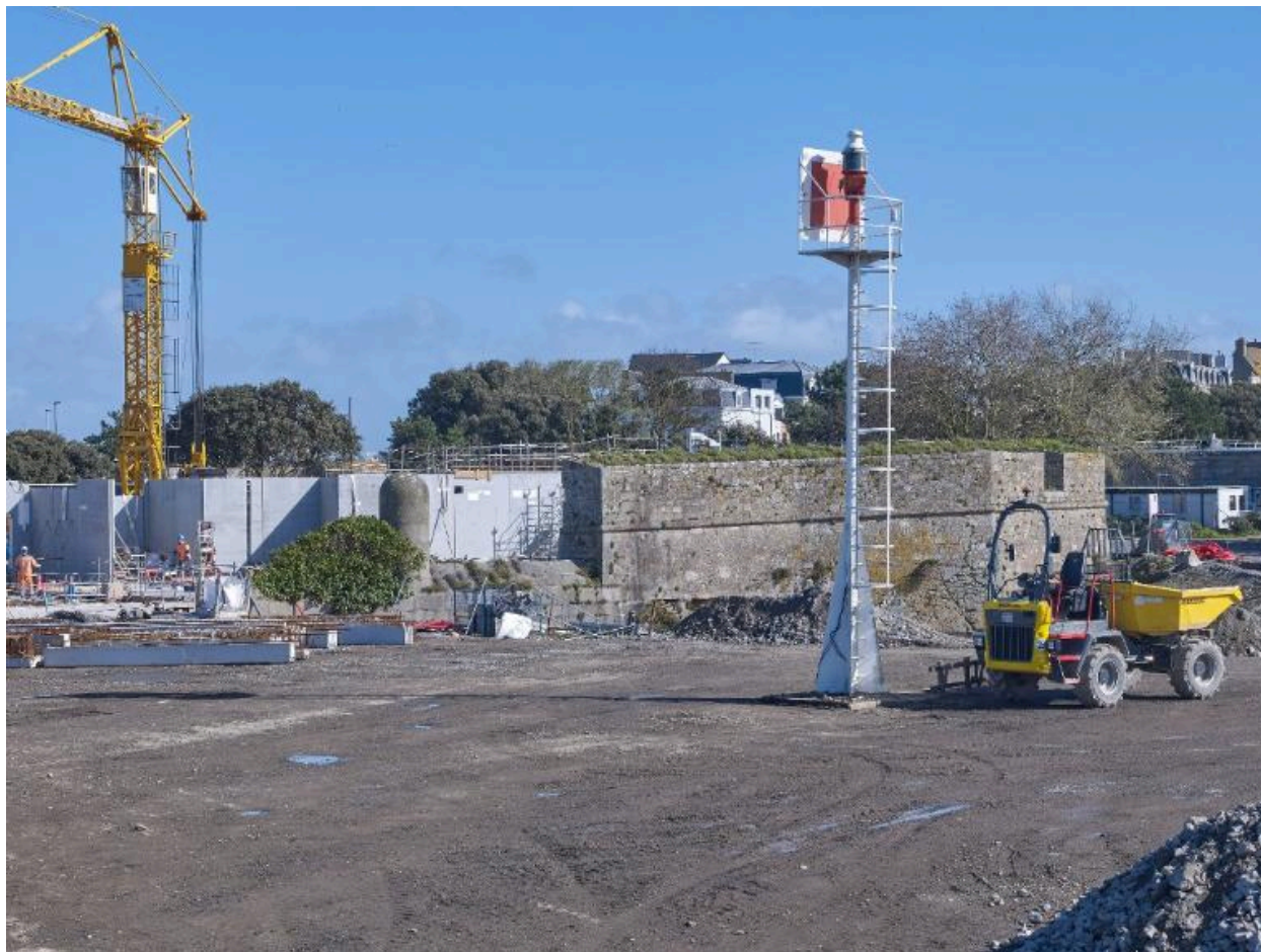
Vue du chantier du terre-plein du Naye (couverture photographique du 11 mars 2026). Au premier plan, un feu de signalisation du port. En arrière-plan, le fort du Naye
