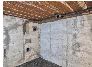
Vue intérieure : pièces de vie - chambrée ouest avec la tuyauterie du système de ventilation. L'emplacement du ventilateur est bien visible sur le mur Phot. Bernard Bègne IVR53_20235600218NUCA
