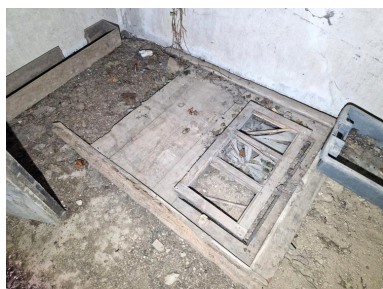
Vue de la porte en bois avec jours gisant au sol dans la pièce ouest Phot. Guillaume Lécueillier IVR53_20232205406NUCA
