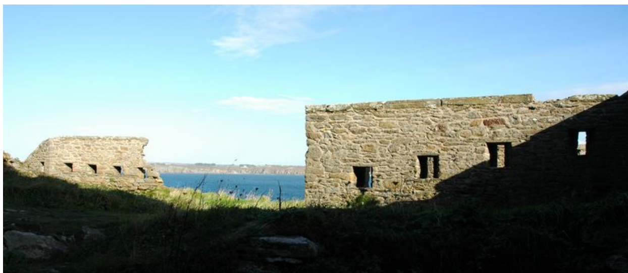
Vue du mur défensif à l'Est (en partie effondré)
