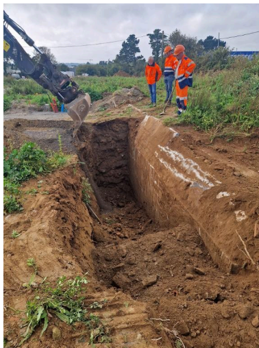
Vue des préparatifs de l'intervention du centre de déminage de Brest dans les deux bunkers du lotissement Alfred Nakache (mercredi 11 octobre 2023). Une pelle mécanique hydraulique a été utilisée pour dégager l'un des deux accès au bunker nord Phot. Guillaume Lécueillier IVR53_20242910467NUCA
