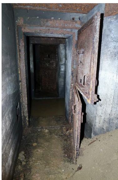
Vue intérieure du bunker - abri de type 502 pour deux groupes de combat (B 25/7) : l'entrée du sas depuis le sud avec sa porte blindée à deux vantaux (photographie réalisée après dépollution pyrotechnique) Phot. Guillaume Lécueillier IVR53_20242910411NUCA
