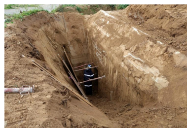
Vue de l'intervention du centre de déminage de Brest dans les deux bunkers du lotissement Alfred Nakache (mercredi 11 octobre 2023). L'accès au bunker sud a nécessité de creuser une importante tranchée à la pelle mécanique hydraulique Phot. Guillaume Lécueillier IVR53_20242910465NUCA
