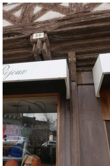
Le poteau central du rez-de-chaussée a été déplacé vers la droite, comme en témoigne la mortaise orpheline sous la solive.
