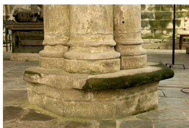
Détail bases de la pile d'entrée du bras sud. Phot. Norbert Lambart IVR53_20072200219NUCA
