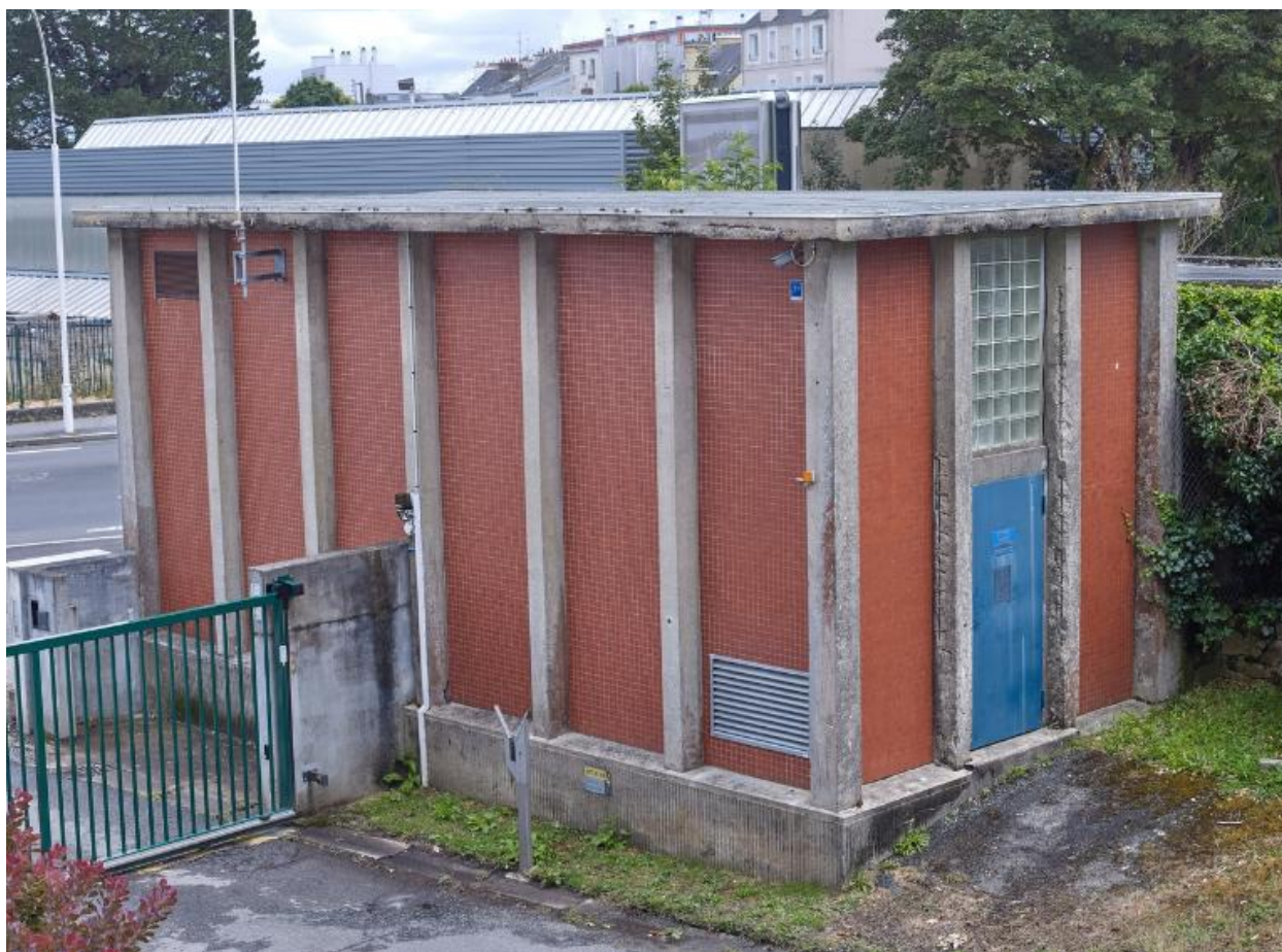
Poste de livraison d'électricité.
