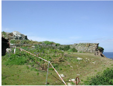
Vue de la batterie nord-ouest en partie effondrée de l'île aux Moines Phot. Guillaume Lécueillier IVR53_20022202523NUCA
