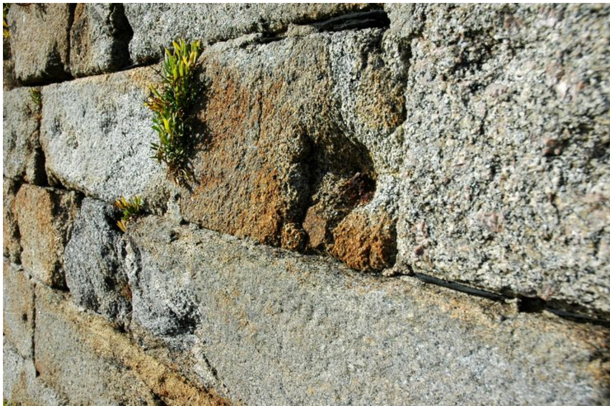
Elévation Sud : détail. Les projectiles en rouillant ont fait éclater le granite
