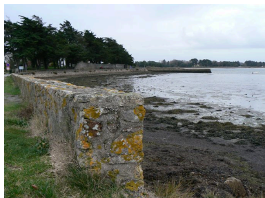
Vue générale de la digue de la Garenne Phot. Julien Amghar IVR53_20085606112NUCA
