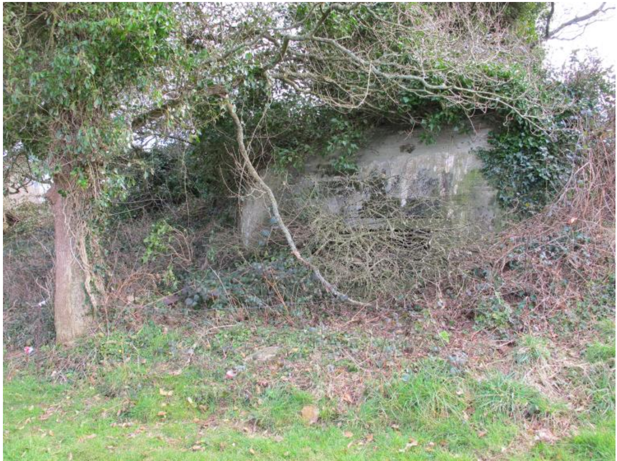
Vue générale (état en 2013). La casemate en béton armé est envahie par la végétation
