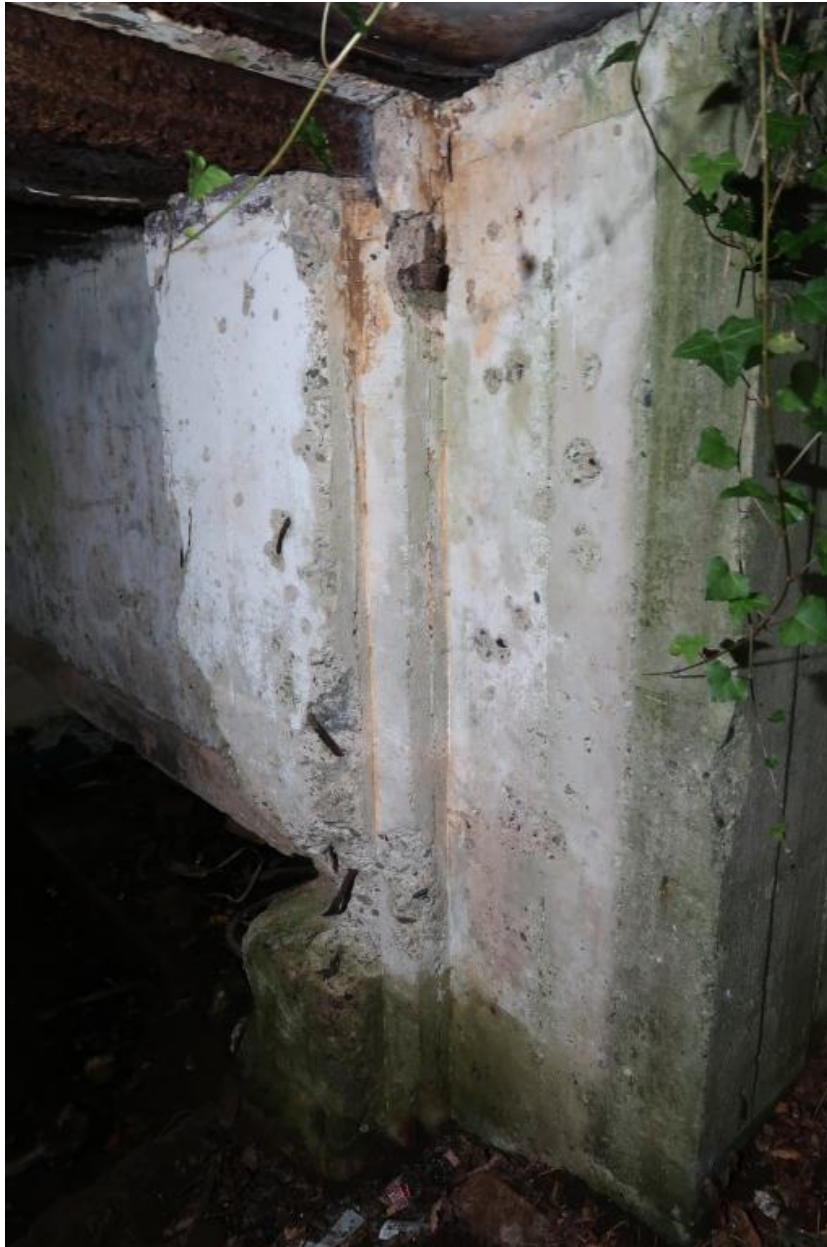
Vue de l'embrasement de la porte de la chambre de tir (état en 2021). On observe des impacts dans le béton...
