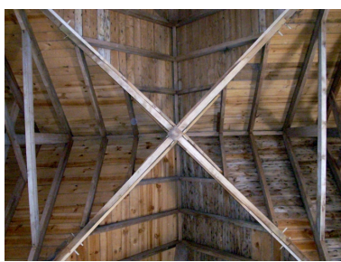
Riec-sur-Belon, chapelle Saint-Gilles : croisée du transept, détail de la charpente Phot. Gwénaél Fauchille IVR53_20082905715NUCA
