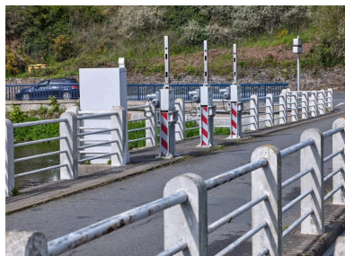
Les vannes sur le déversoir du bassin à flot Phot. Bernard Bègne IVR53_20262200223NUCA
