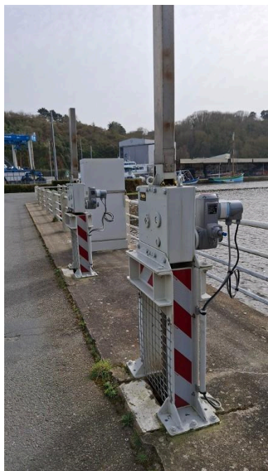
Vue du système de vannes Phot. Erwana L'Haridon IVR53_20262210231NUCA
