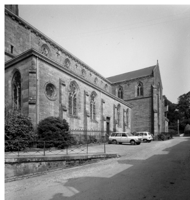
Châteaulin, église paroissiale Saint-Idunet : façade sud, vue d'ensemble, état en 1972 Phot. François Dagorn IVR53_19722900936V
