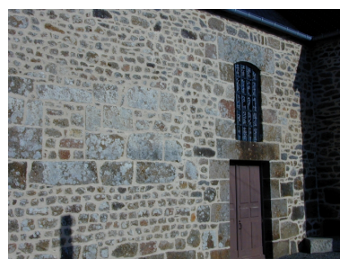
Porte donnant sur le cimetière et fenêtre murée : vue générale sud-ouest Phot. Xavier Gilbert IVR53_20013517551NUCA
