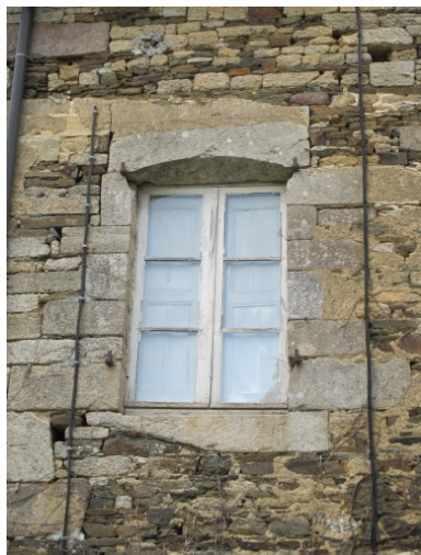
Logis, pignon sud, détail de la fenêtre de la chambre Phot. Véronique Orain IVR53_20102211866NUCA
