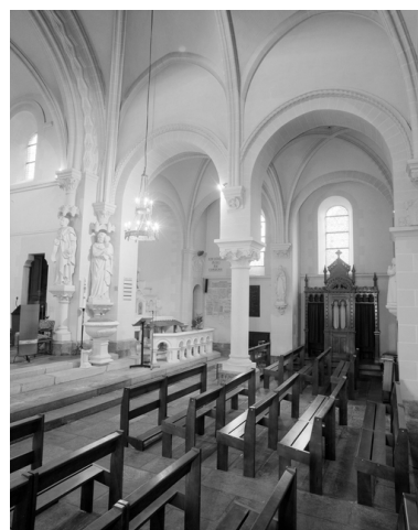
Vue générale intérieure droite. Phot. Service régional de l'Inventaire de Bretagne IVR53_19943500092X
