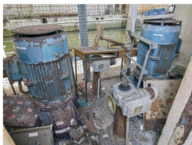
Vue des deux moteurs électriques de deux pompes du bassin (pompes situées entre les bassins F et G) Phot. Bernard Bègne IVR53_20235600034NUCA
