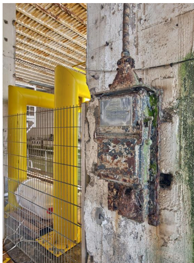
Vue du boîtier (fermé) de l'une des prises électriques triphasées du bassin F. Sur le boîtier : informations ("115 v 60 Hz 125 A Bassin F") et consignes de sécurité Phot. Bernard Bègne IVR53_20235600035NUCA
