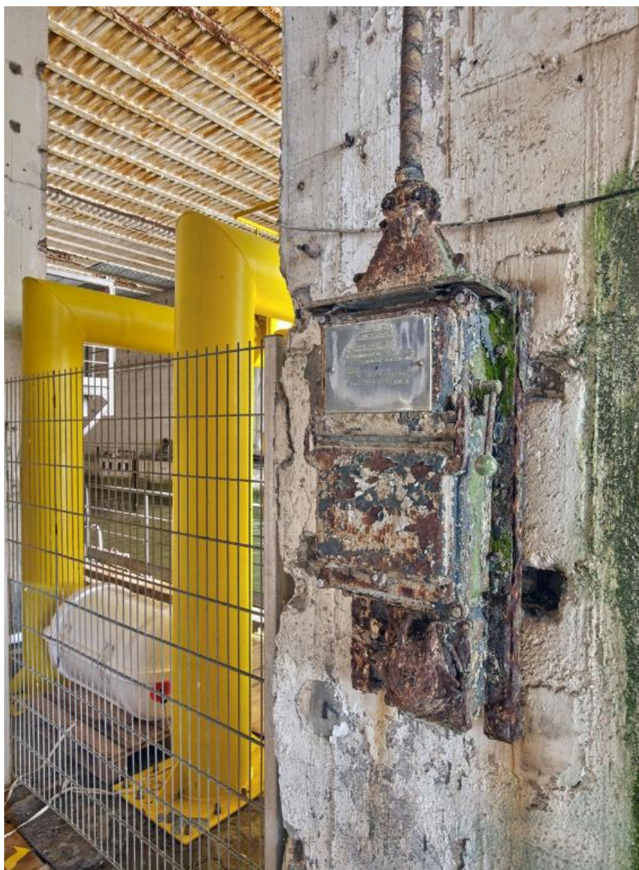
Vue du boîtier (fermé) de l'une des prises électriques triphasées du bassin F. Sur le boîtier : informations ("115 v 60 Hz 125 A Bassin F") et consignes de sécurité
