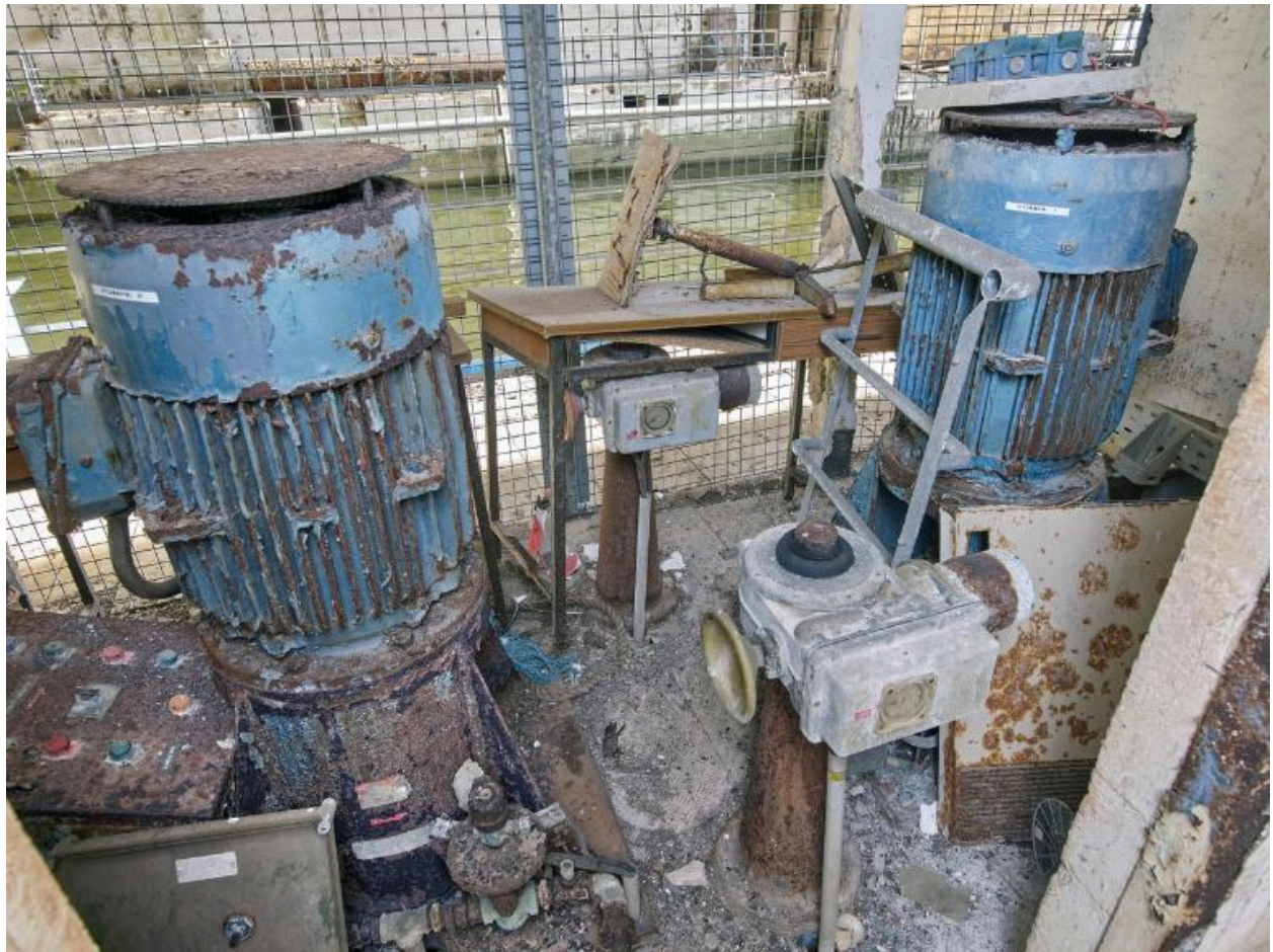
Vue des deux moteurs électriques de deux pompes du bassin (pompes situées entre les bassins F et G)
