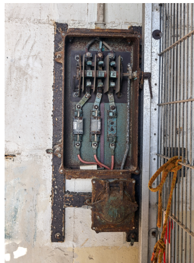
Vue du boîtier (ouvert) de l'une des prises électriques triphasées du bassin F Phot. Bernard Bègne IVR53_20235600036NUCA
