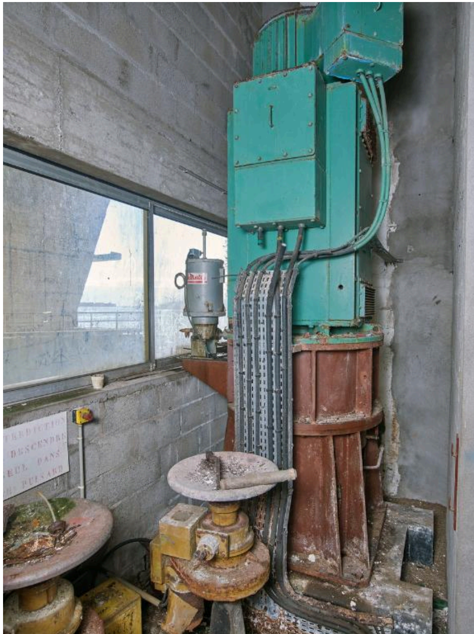
Vue du corps de pompe du bassin F. Au premier plan, la commande à volant de la pompe. Une manivelle est posée sur le volant
