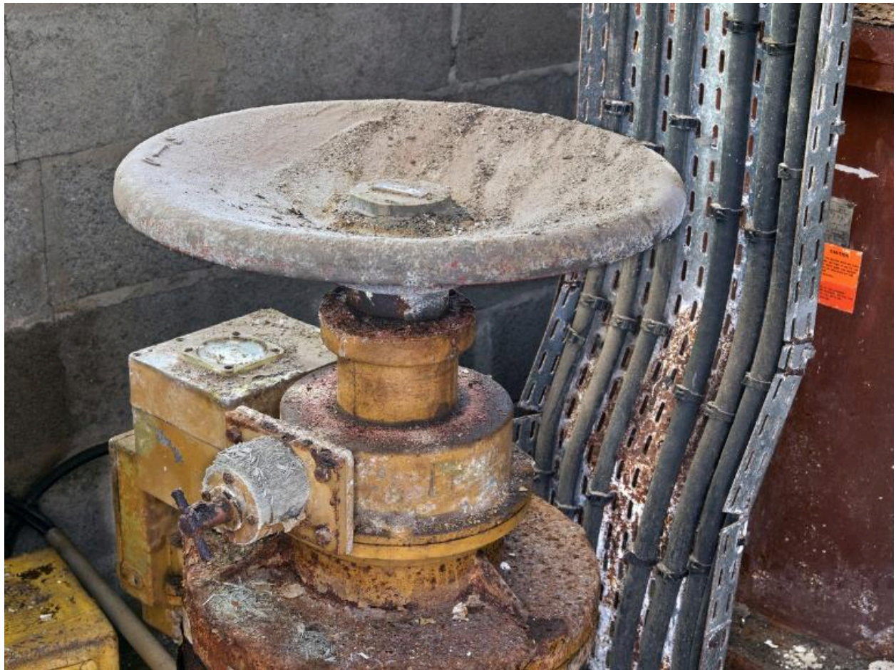
Vue de détail de la commande à volant de la pompe du bassin F
