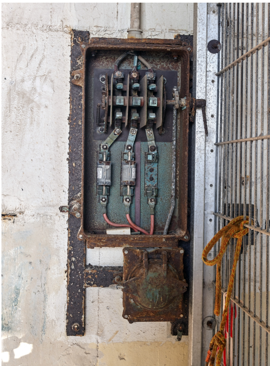
Vue du boîtier (ouvert) de l'une des prises électriques triphasées du bassin F
