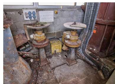
Vue des commandes à volant des pompes des bassins G et F. Deux manivelles sont posées sur les volants Phot. Bernard Bègne IVR53_20235600028NUCA
