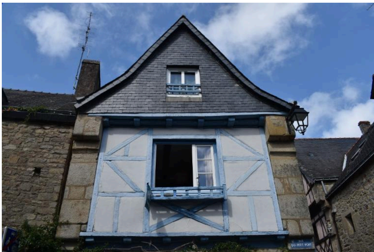
Détail de la façade à pan de bois avec encorbellement et essentage d'ardoises
