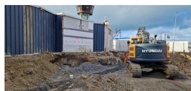
Vue de situation sous la gare maritime du Naye (couverture photographique du 22 janvier 2026). La dalle de couverture du bunker dépasse d'environ 1 m de hauteur Phot. Guillaume Lécueillier IVR53_20263510177NUCA
