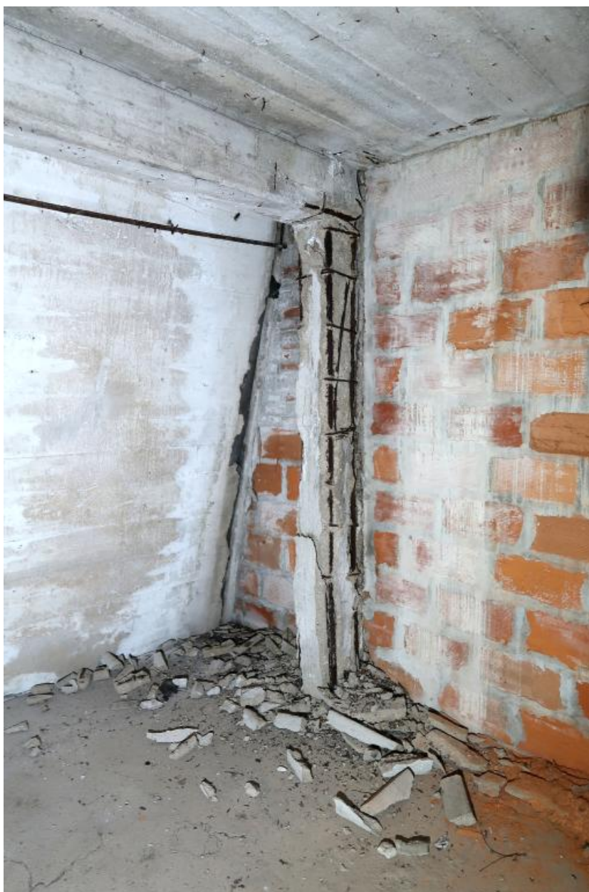
Deuxième étage : pilier en béton armé corrodé
