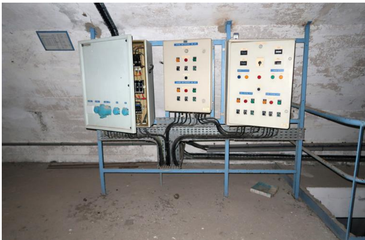
Quatrième étage (cinquième niveau) : tableaux électriques
