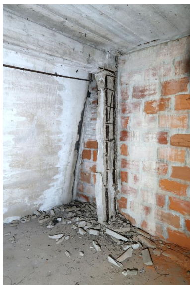
Deuxième étage : pilier en béton armé corrodé Phot. Guillaume Lécueillier IVR53_20225606253NUCA
