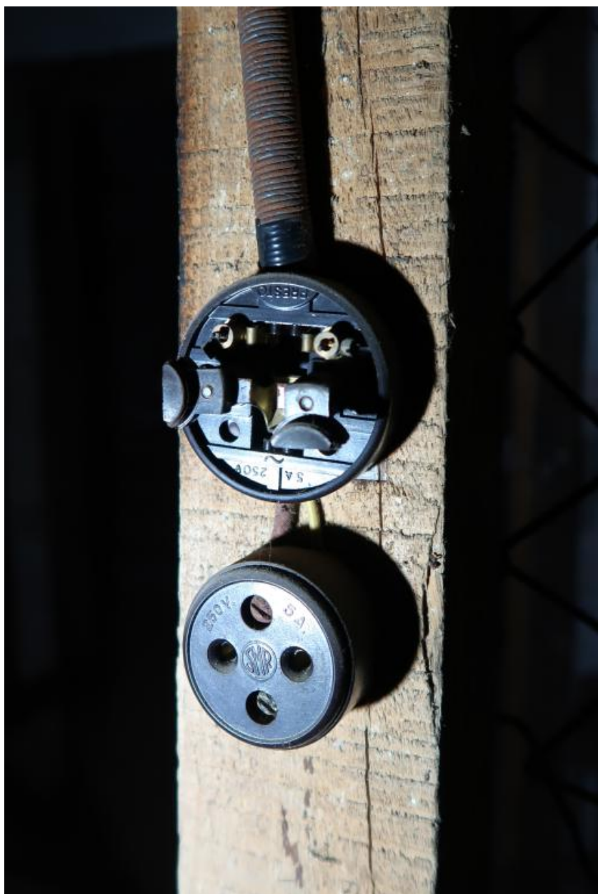
Premier étage : interrupteur et prise de marque SMR 250 V. 5A.
