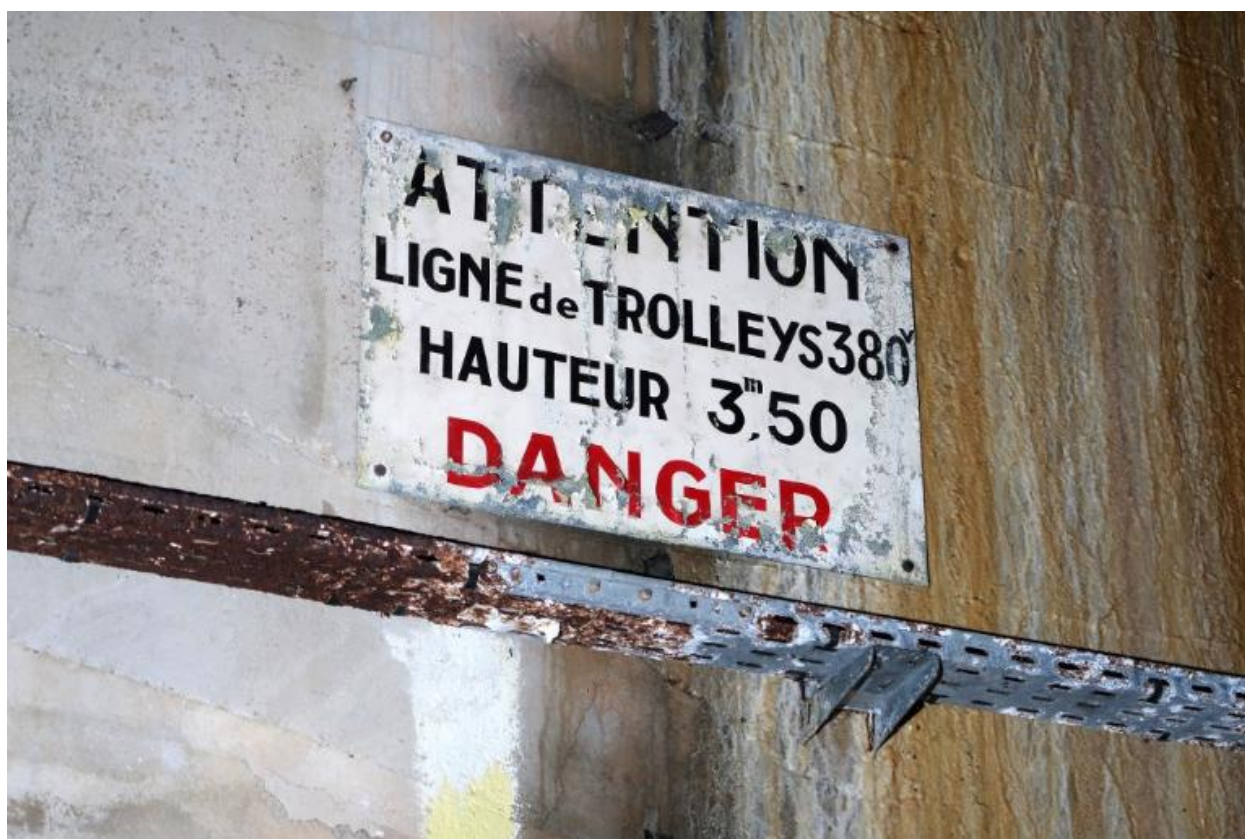
Vue de l'extension nord-ouest : signalétique du treuil du troisième étage. On peut lire : ATTENTION LIGNE de TROLLEYS 380 V HAUTEUR 3m50 DANGER
