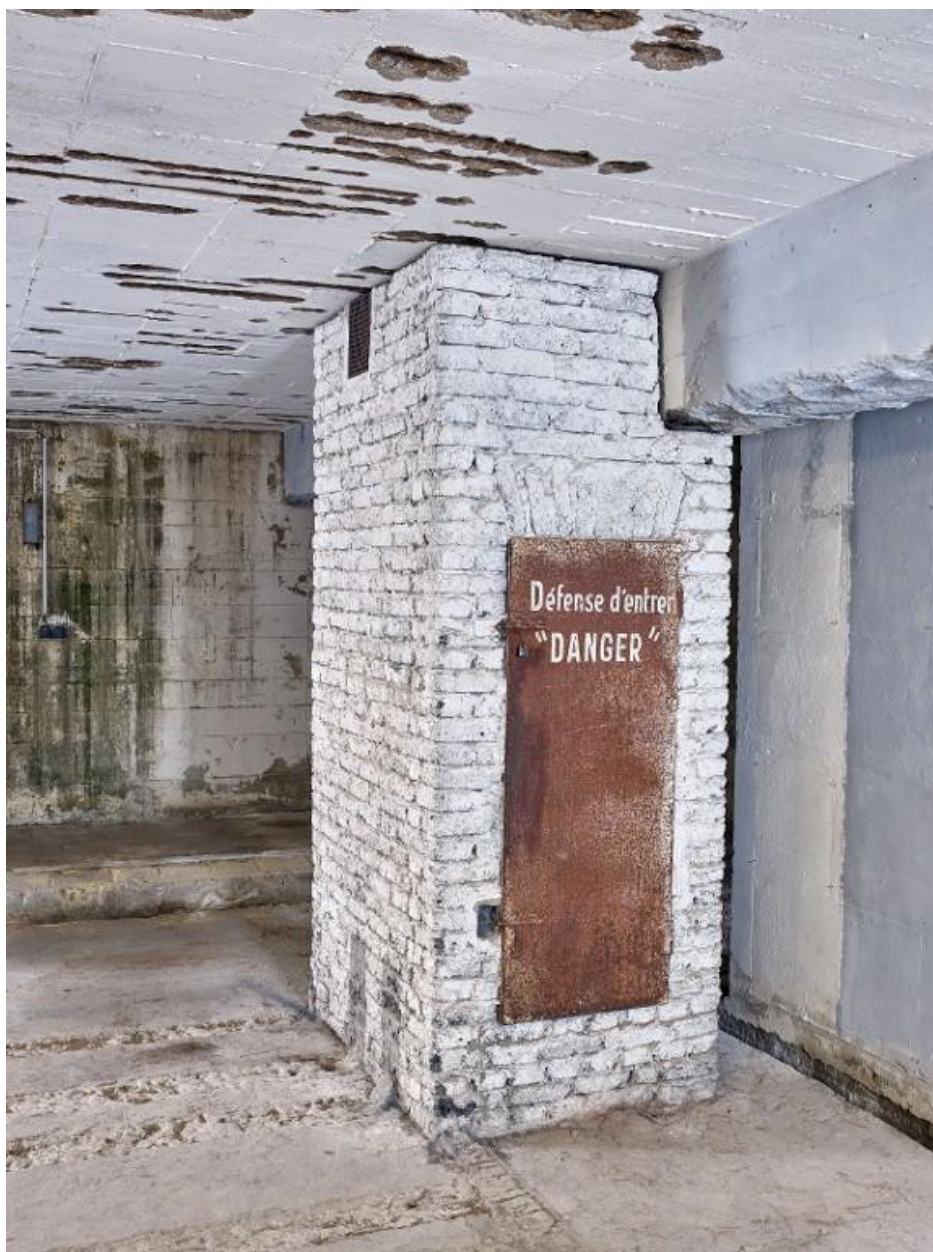
Vue de l'extension nord-ouest : rez-de-chaussée, puits d'accès en brique aux réservoirs situés au sous-sol. On peut lire : Défense d'entrée DANGER
