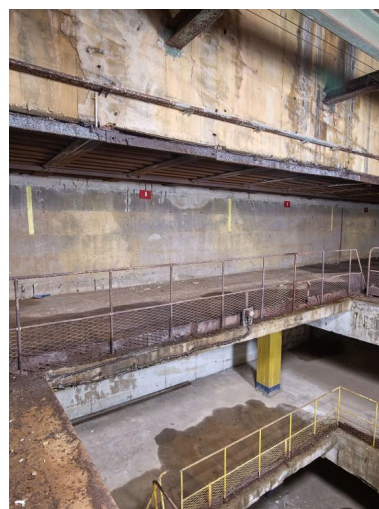
Vue de l'extension nord-ouest : puits du monte-charge depuis le troisième étage Phot. Bègne Bernard IVR53_20235600751NUCA
