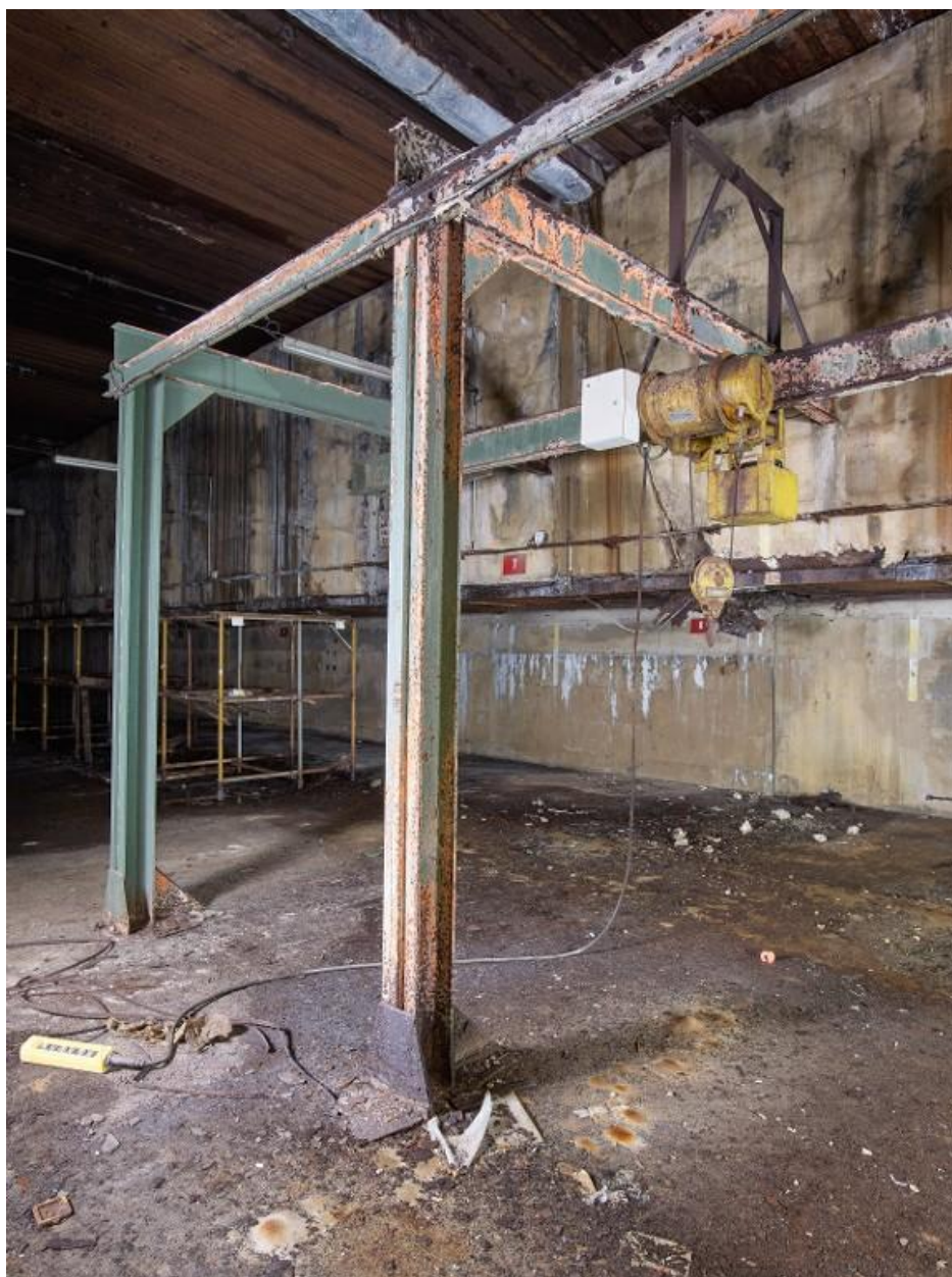
Vue de l'extension nord-ouest : potence et treuil d'une capacité de 3 tonnes au troisième étage
