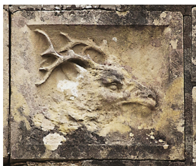
Façade d'entrée, bas-relief, tête de cerf Phot. Guy Artur, Phot. Norbert Lambart IVR53_20033500225NUCA
