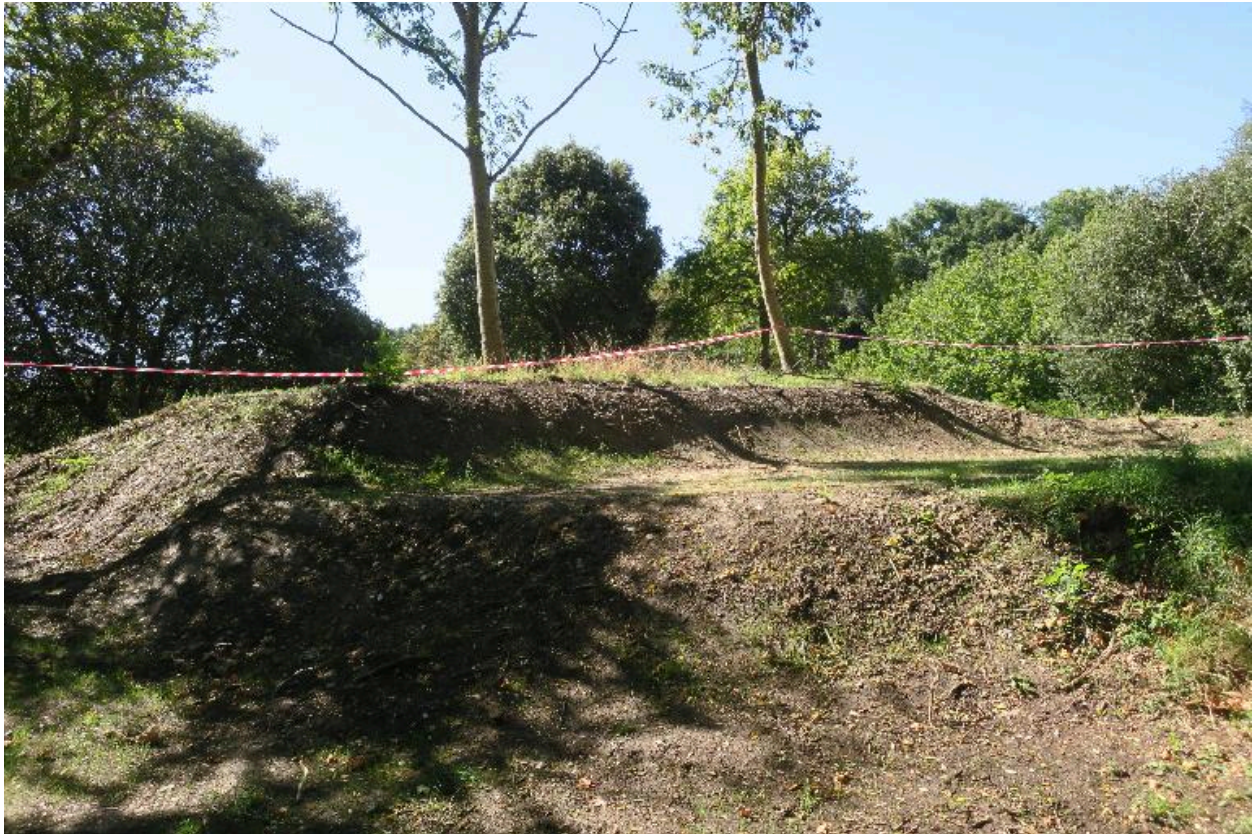
Le Palais, enceinte urbaine, bastion 21, parapet altéré par des travaux récents (août 2017).
